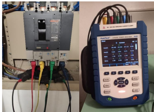
Figura 2.16 – Monitorização de consumos elétricos com um analisador de energia.
