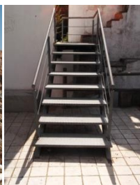
[Fig. 108] Escadas Metálicas
