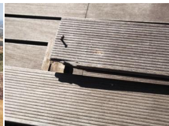
[Fig. 34] Estrutura Madeira: Estado
