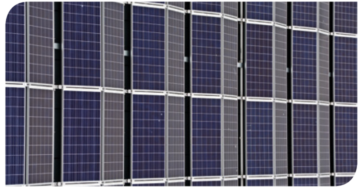
Figura 4 Painéis fotovoltaicos (Imagem por bernswael, via Pixabay).
