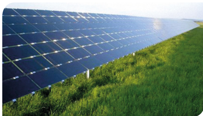
Figura 3 Instalação fotovoltaica de filme fino de CdTe (via Wiki Commons, NREL [Public domain]).
