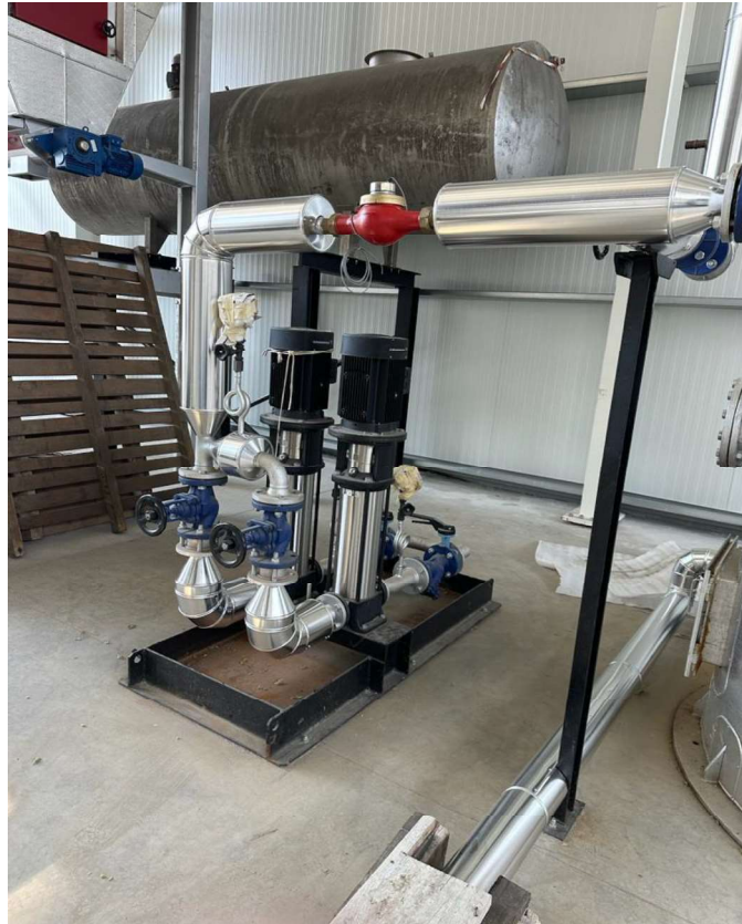
Figura 11 - Grupo de bombagem.
