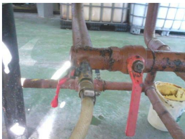
Torneira de fundo do meio do filtro.
