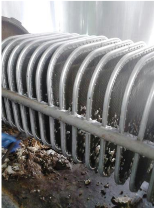
Placas de filtração após filtração.
