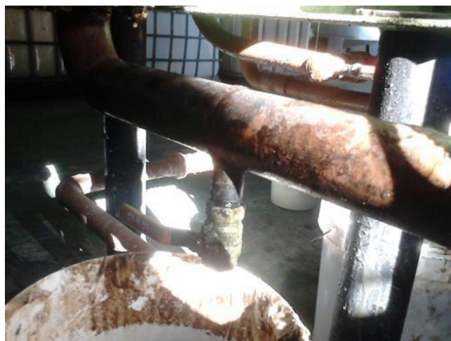
Torneira de fundo da entrada do filtro.
