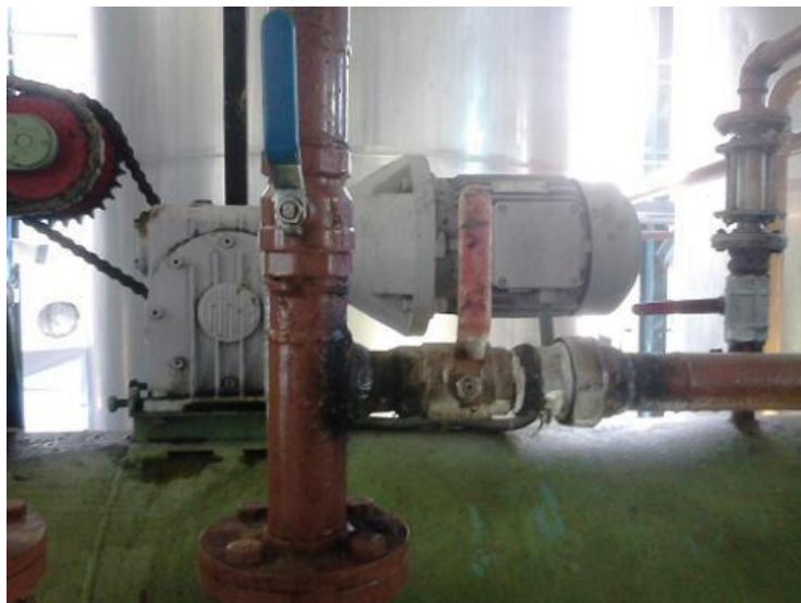
Torneiras de saída do filtro.
