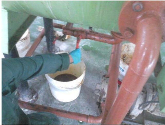
Torneira do fundo de saída do filtro.
