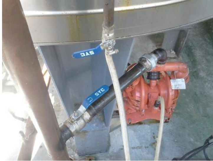
Torneira de saída da bomba, torneira de ar da bomba e bomba ar.
