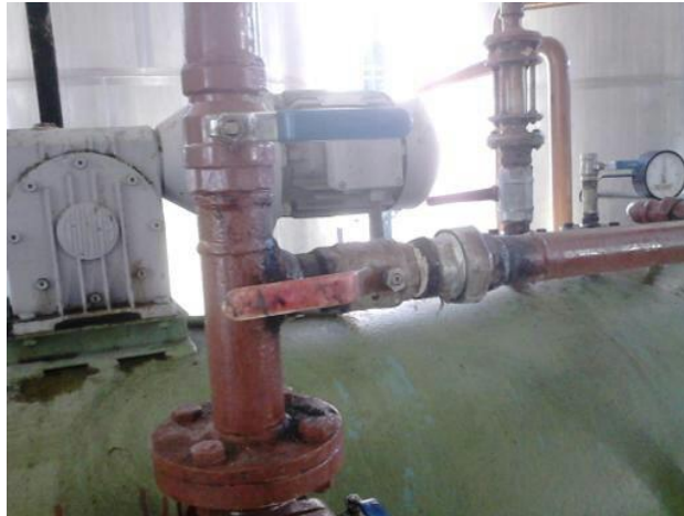
Torneiras de saída do filtro.
