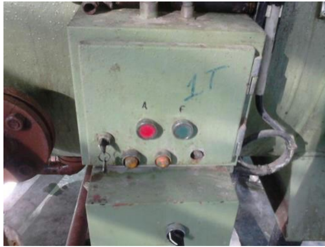
Quadro elétrico do filtro e comando da abertura e fecho do mesmo.
