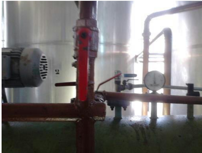
Torneira de saída do filtro para a recirculação.
