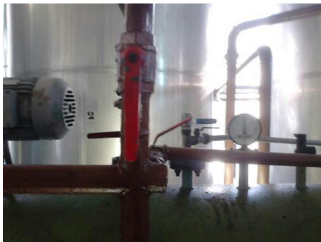
Torneira de saída de recirculação entre o filtro e secador.
