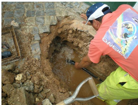
Figura 3.11 – Rotura na tubagem do ramal (cedida por Professor Joaquim Sousa)
