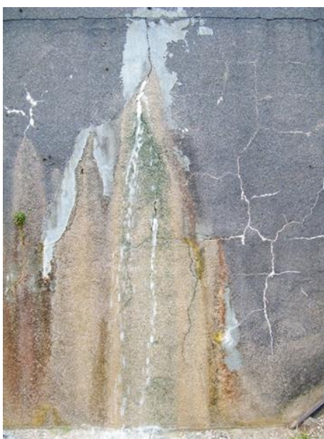
Figura 3.15 – Fissura no reservatório (cedida por Professor Joaquim Sousa)
