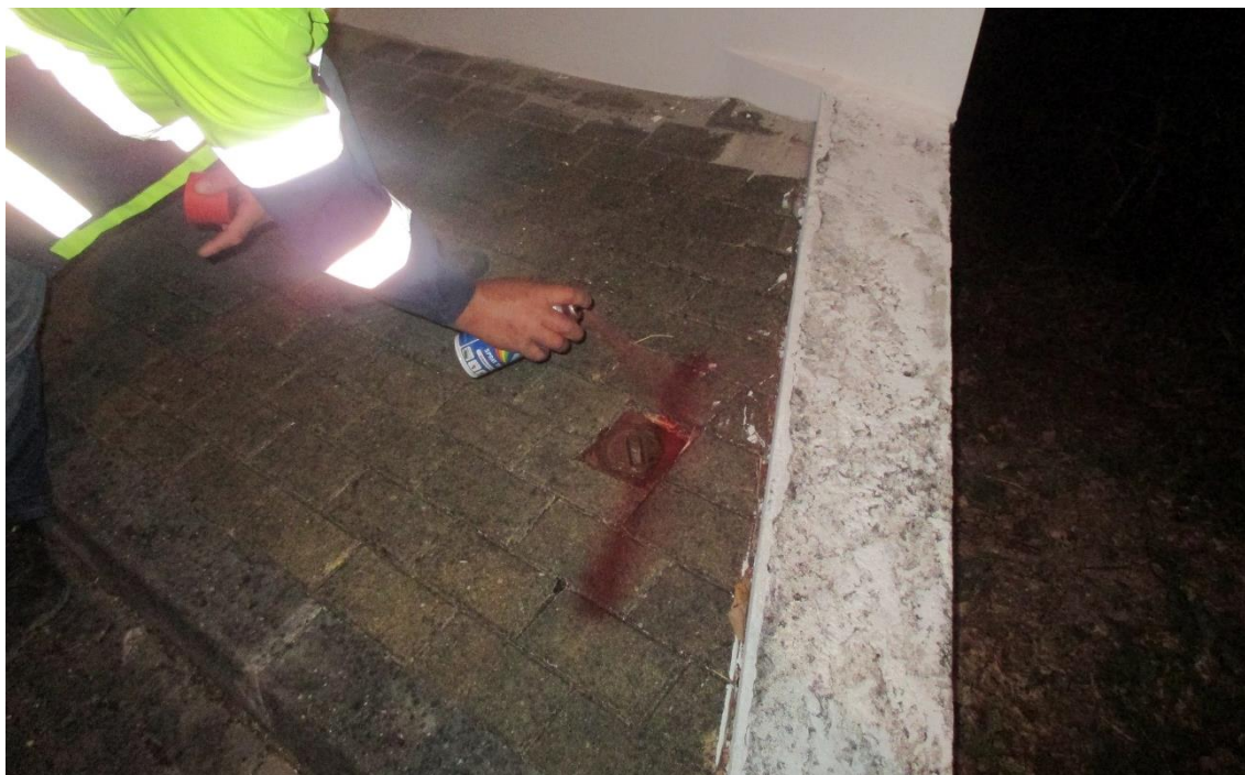
Figura 4.11 – Identificação de rotura com spray.
