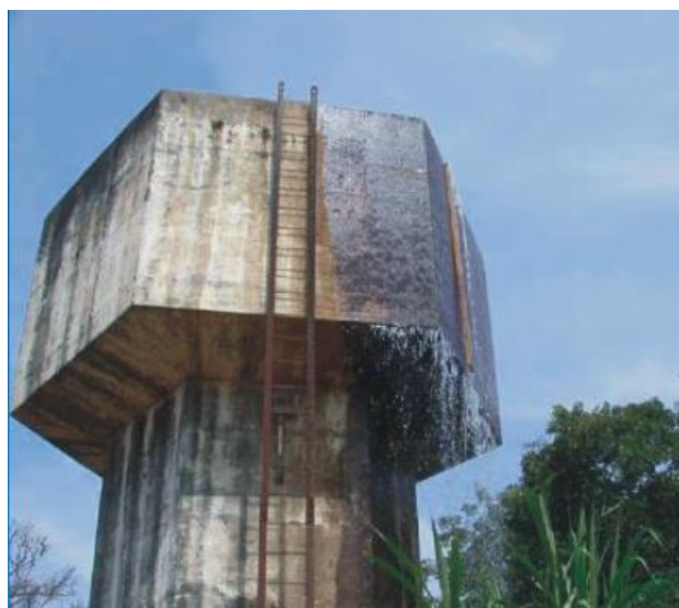
Figura 3.16 – Extravasamento do reservatório (Apontamentos das aulas de Hidráulica Urbana)
