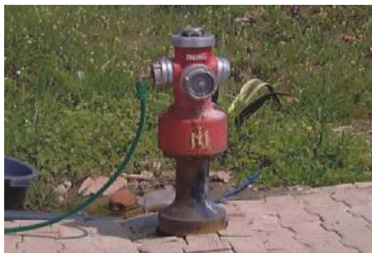
Figura 3.4 - Uso fraudulento dos hidrantes (apontamentos das aulas de Hidraulica Urbana)
