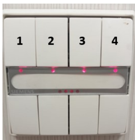
Figura 55 - Interruptor de quatro teclas que liga/desliga a iluminação da sala
