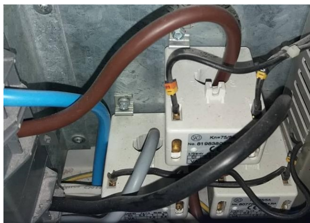
Figura 64 - Transformadores de corrente localizados no QG
