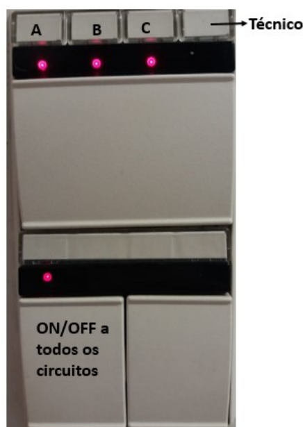
Figura 51 - Interruptor dos circuitos do armazém
