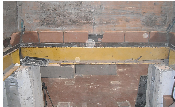
(b) Junta inclinada entre os tijolos no fecho da fiada
