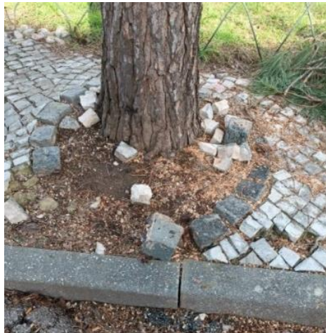
Figura 39 - Exemplo de uma caldeira em mau estado presente no interior do bairro (fotografia do autor)
