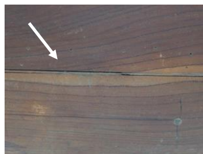
Figura 122 Costas do contador; pormenor da fratura existente. Fonte: el. pr.
