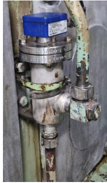
Figura 63- Sensor de detecção de fugas de combustível da máquina principal.
