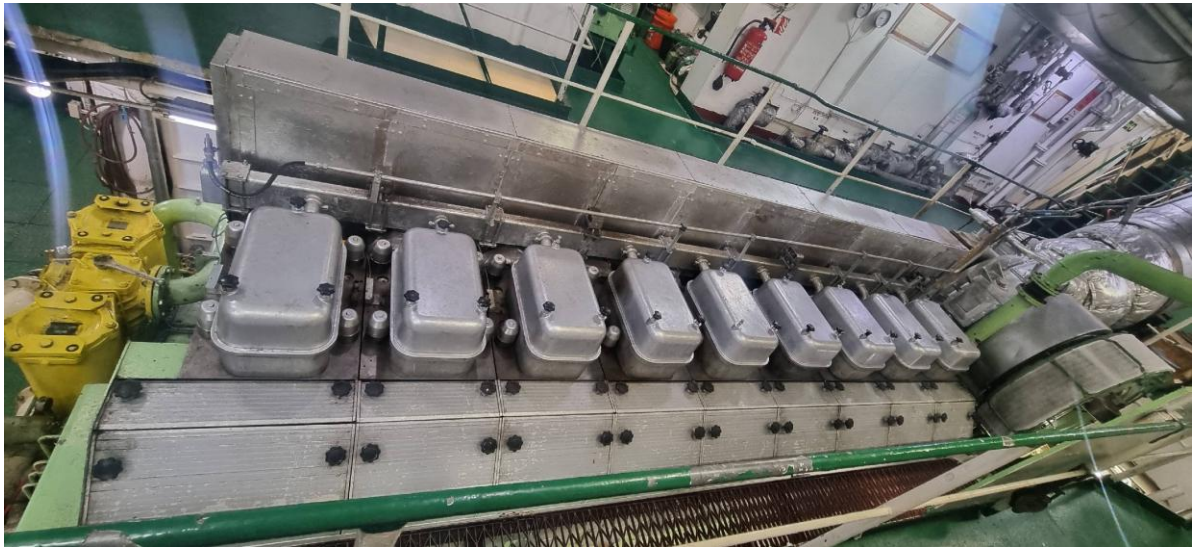
Figura 19- Máquina principal de propulsão.
