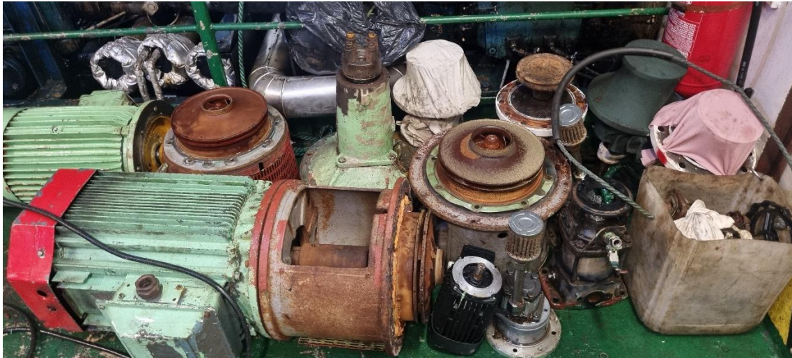
Figura 48- Bombas e motores elétricos desacoplados para manutenção.
