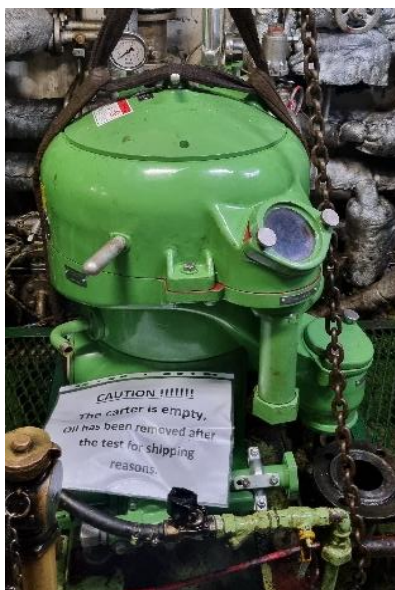
Figura 40- Fixação de uma depuradora.
