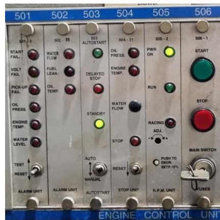
Figura 66- Painel de controlo do gerador auxiliar.
