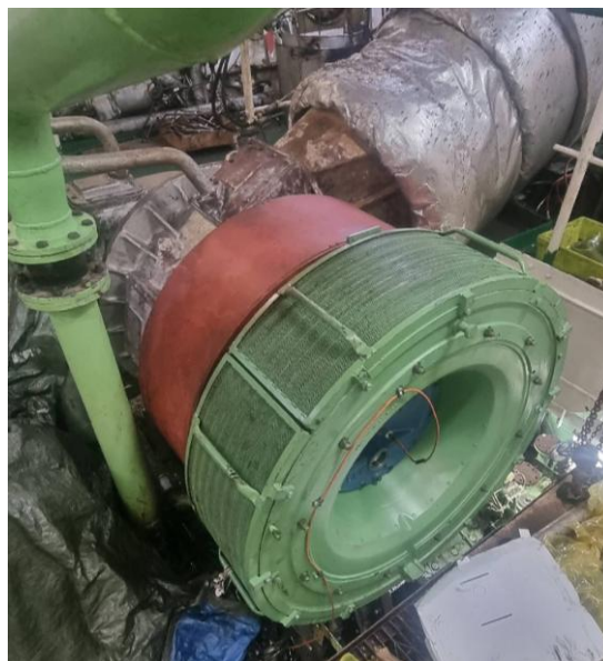
Figura 31- Turbocompressor montado após manutenção.
