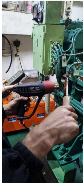
Figura 68- Teste de alarmes e seguranças de temperaturas elevadas do gerador.
