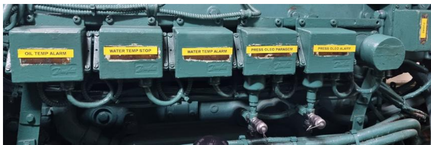
Figura 67- Equipamentos de segurança e controlo do gerador.
