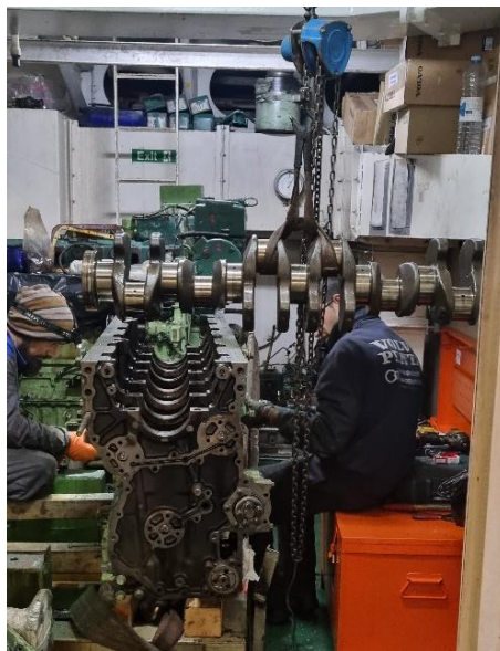
Figura 34- Manutenção dos geradores auxiliares.
