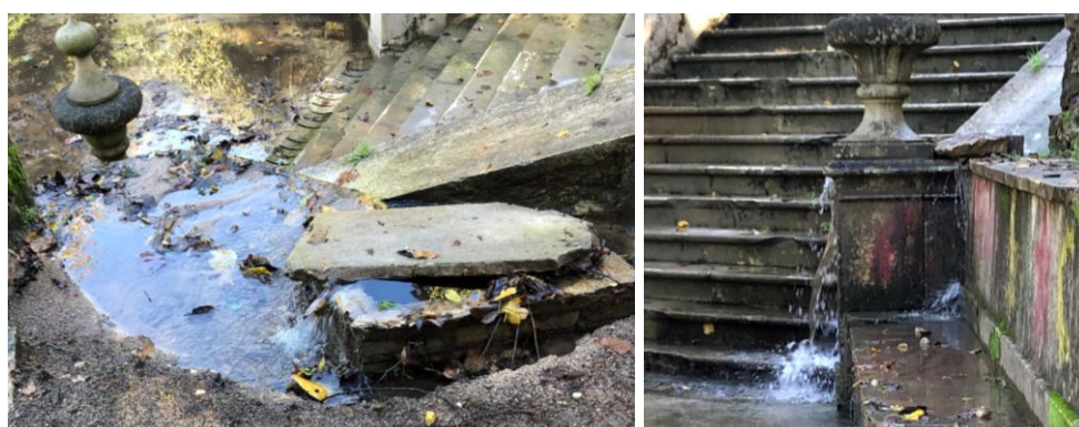
Figura 10 – Inundação provocada pela obstrução (fotografia da autora)
