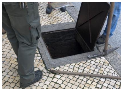
Figura 38 – Caixa de visita (fotografia da autora)
