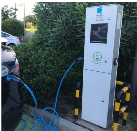
Figura 73 – Fotografia de uma torre de carregamento ( https://shre.ink/Qi5e )
