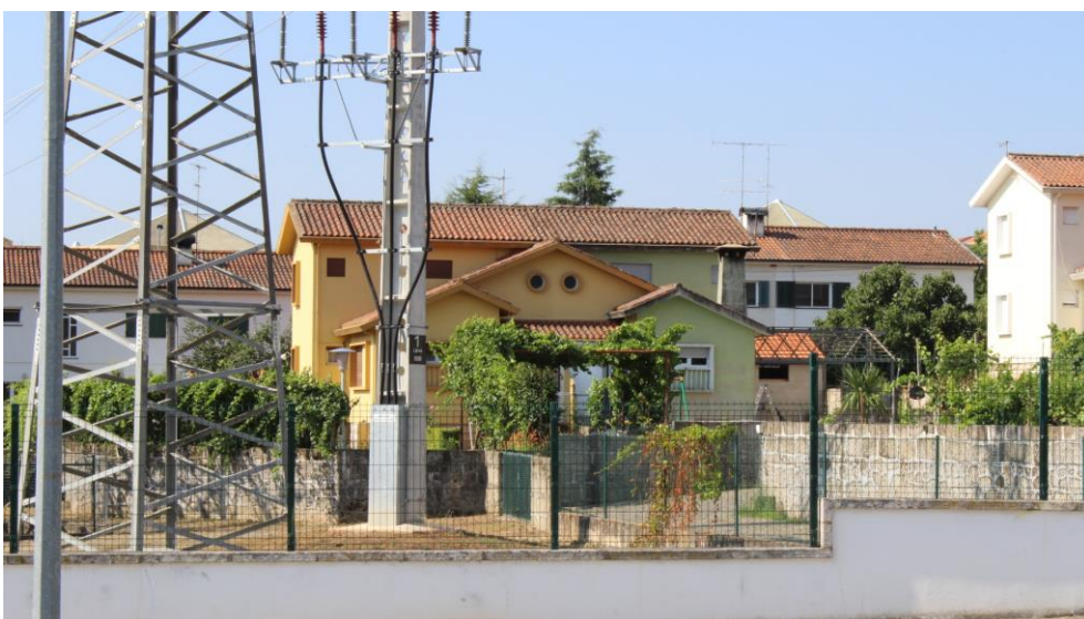
Figura 34. Subestação elétrica. Bairro da Chenop. Atual.
