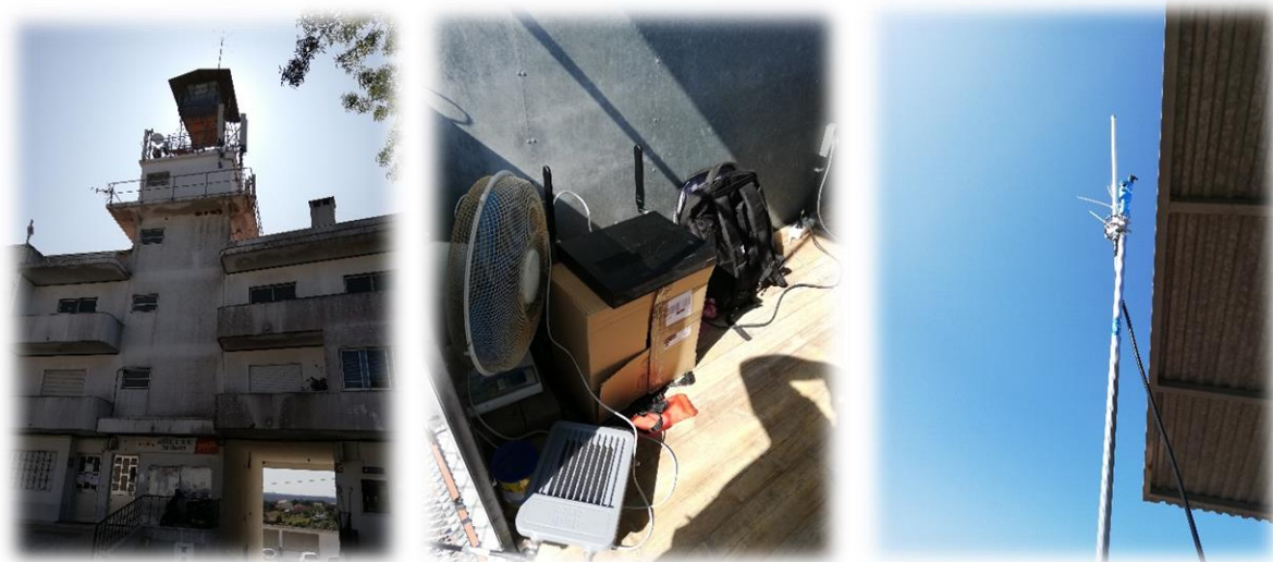
Figura 41 – Local elevado de instalação de antena e gateway LoRa
