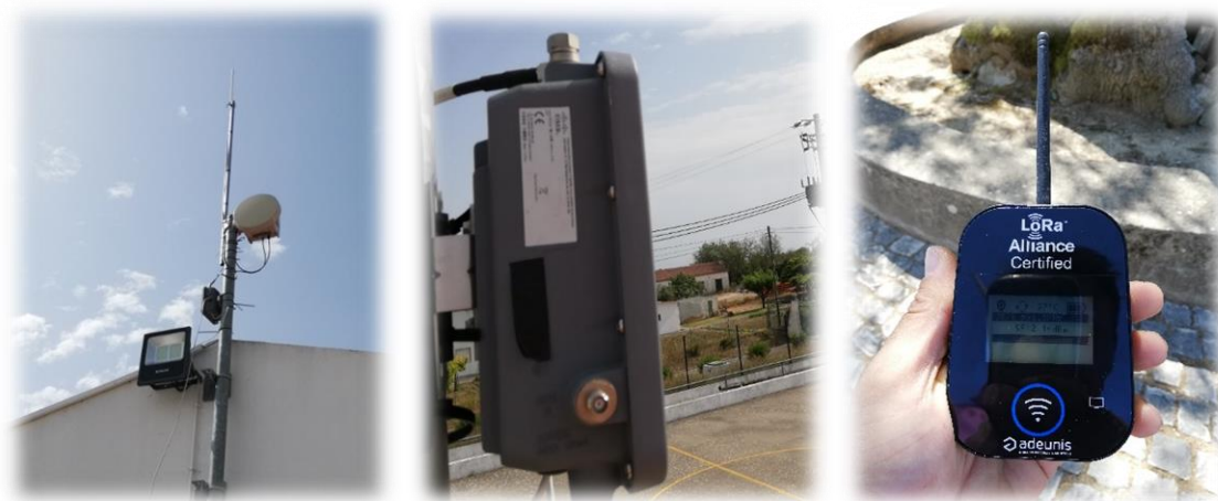
Figura 24 - Equipamentos LoRa utilizados no survey realizado no concelho de Tomar
