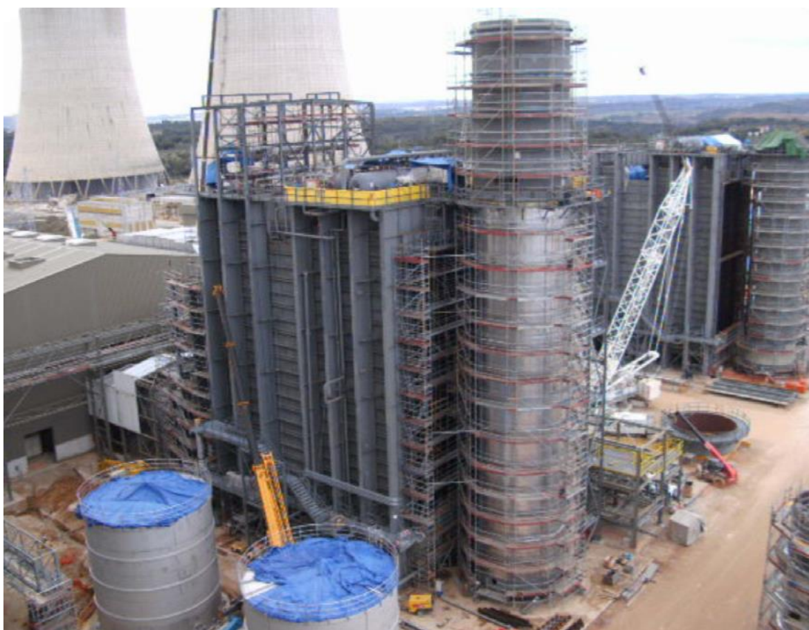
Figura 30 – Caldeira de recuperação de calor (Fonte própria).
