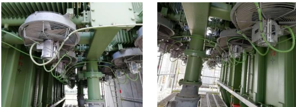
Figura 70 – Ventiladores beneficiados (Fonte própria).
