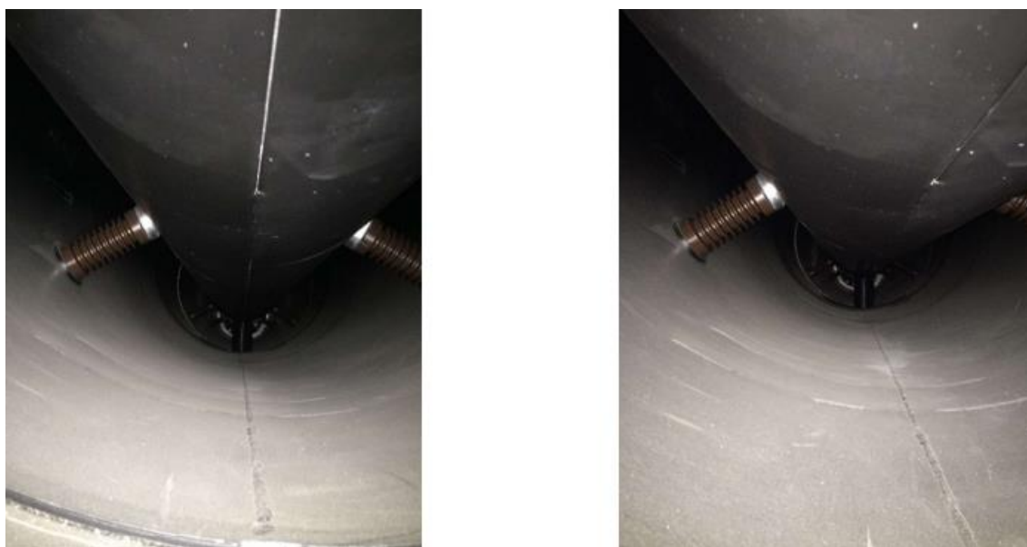
Figura 66 – Interior das condutas 40BAA (Fonte própria).
