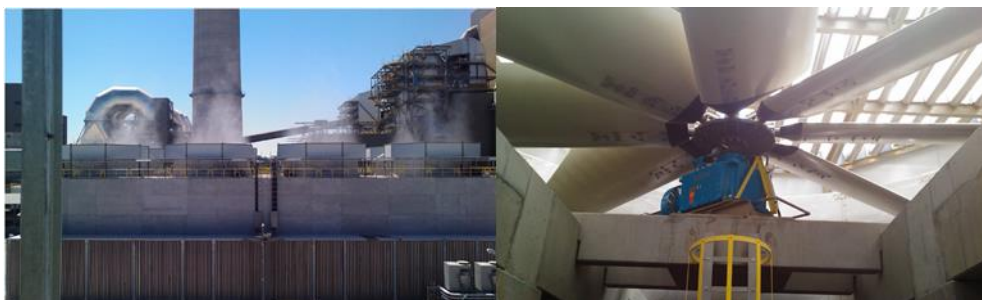
Figura 33 - Torres de Refrigeração
