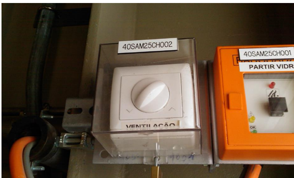
Figura 6 – KKS do Equipamento em chapa plástica (Fonte própria).
