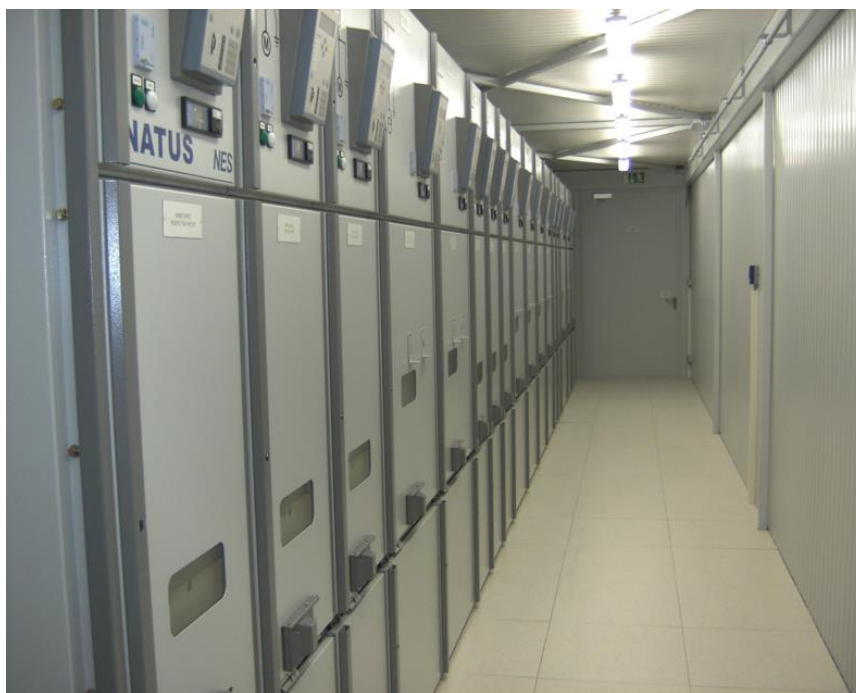
Figura 57 – Aparelhagem de Alta Tensão.
