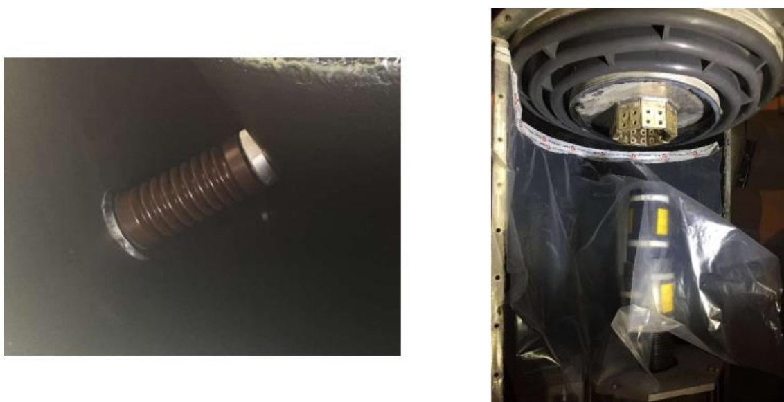
Figura 67 – Estado geral e limpeza suportes e reparação fuga junto ao Alternador (Fonte própria).
