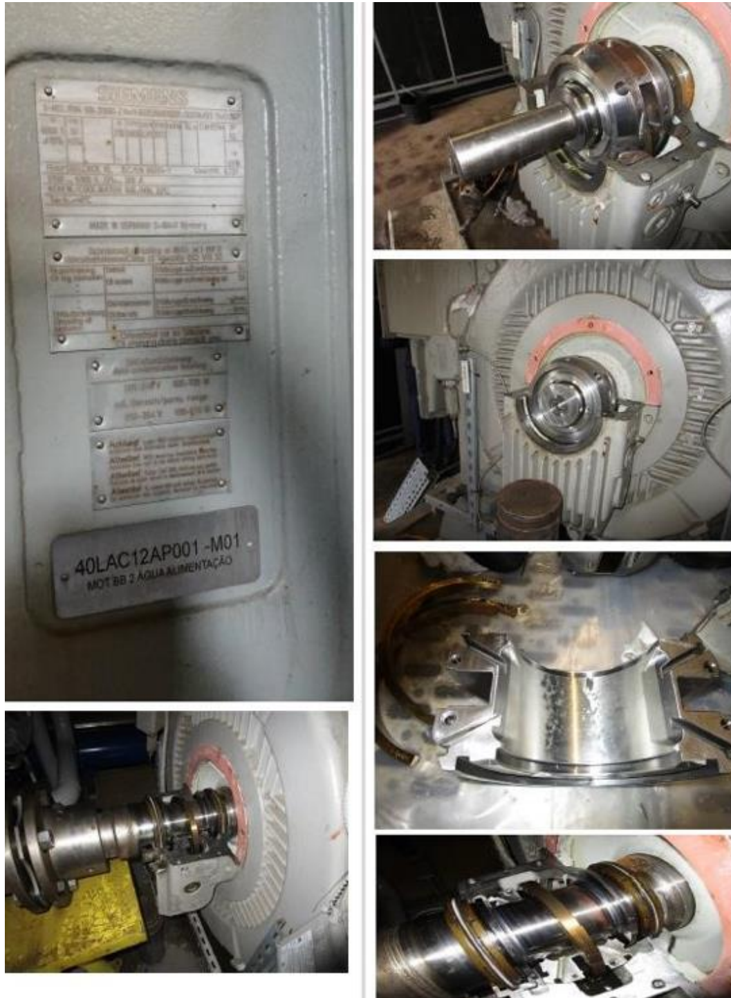
Figura 79 – Verificações do estado geral das chumaceiras do motor (Fonte Própria).
