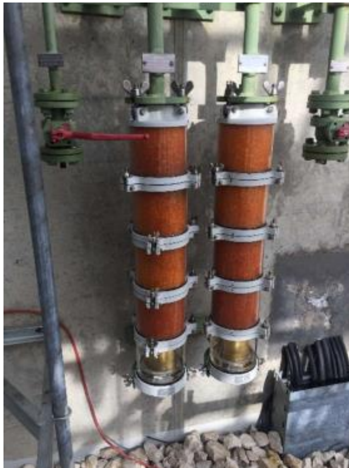
Figura 72 – Sílica-gel Transformador (Fonte própria).
