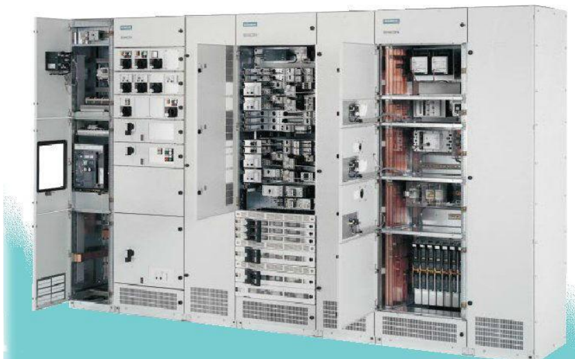
Figura 60 – Aparelhagem de Baixa Tensão.
