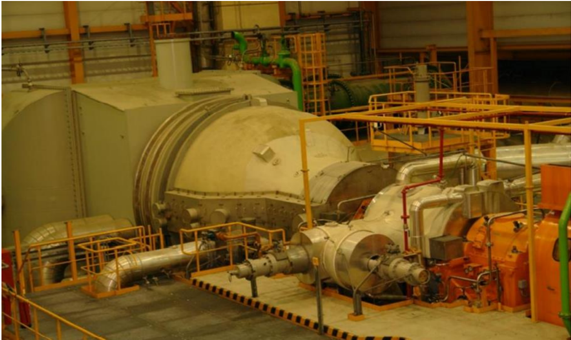
Figura 27 – Turbina a vapor [16].
