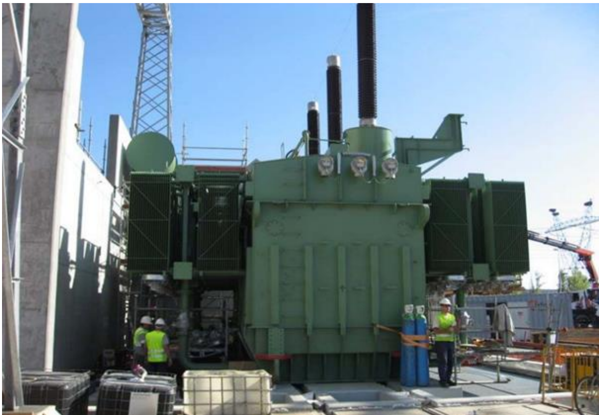
Figura 40 – Transformadores 400/20 kV EFACEC 505 MVA (Figura 41).
