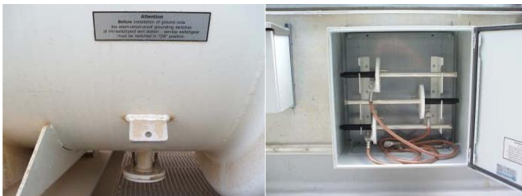
Figura 51 – Dispositivo de terra temporário barramento
