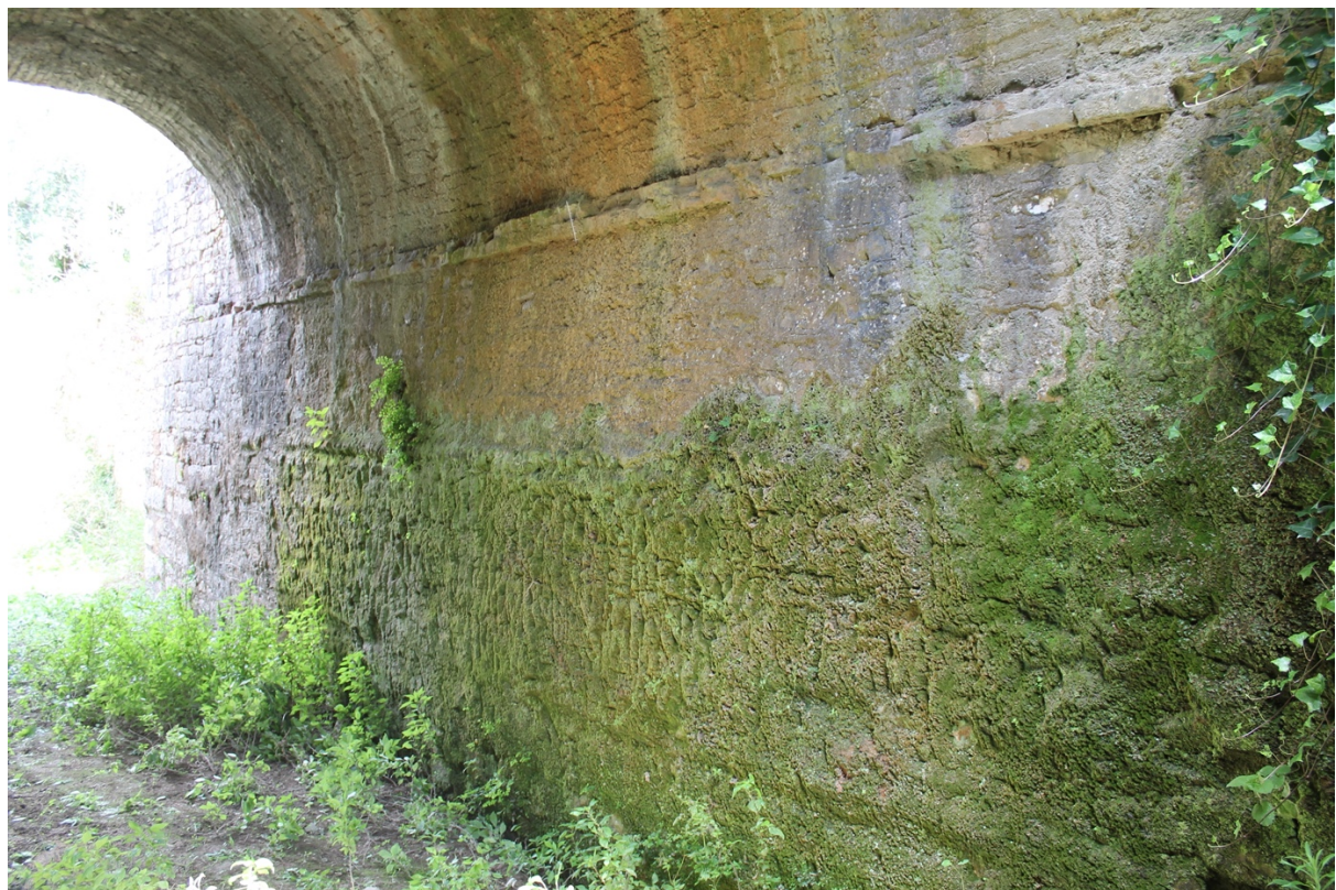
Fig. 29 – Mur 1006 et concrétions calcaires les recouvrant (F. Ferreira 2021)
