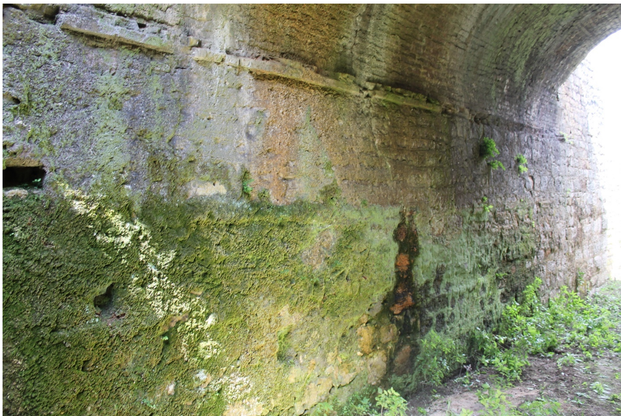
Fig. 30 –Mur 1007 et concrétions calcaires les recouvrant (F. Ferreira 2021)
