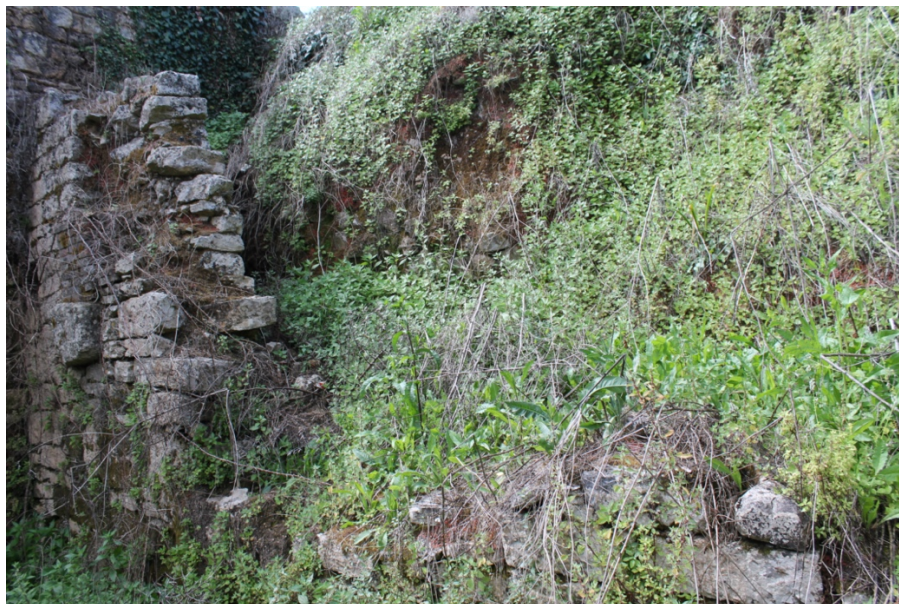
Fig. 51 – Mur 1018 présentant un état particulièrement ruiné
