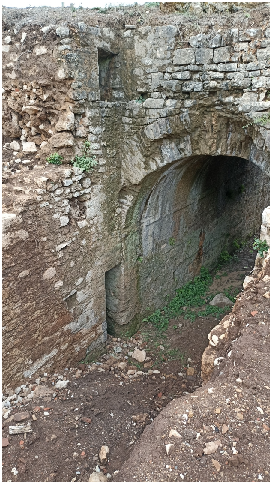
Fig. 15 –Jonction entre les murs 1001 et 1002 et vue de la voûte (1001-1) partiellement effondrée (F. Ferreira 2022)
