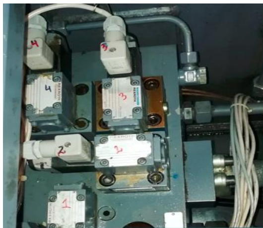
Figura 62 - Válvulas hidráulicas no bloco
