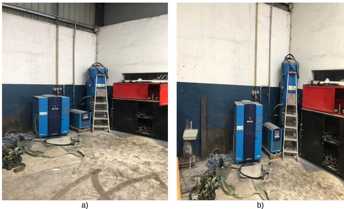
Figura 4.18. Zona do Compressor de Ar.
