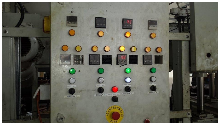
Figura 16 - Quadro de controlo das prensas
