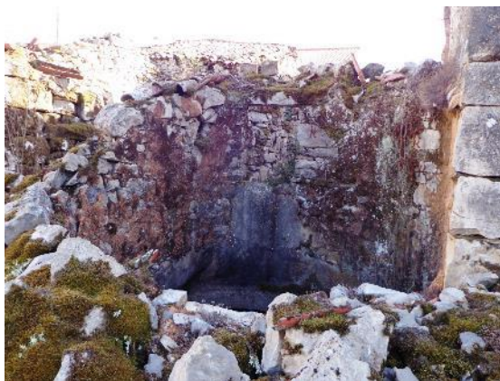
Figura 374 – Colapso de telhado de poço
