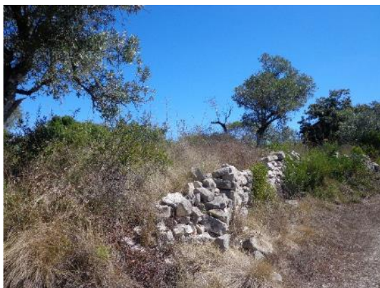
Figura 368 - Deficiente travamento entre panos de parede
