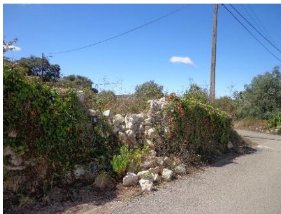
Figura 366 - Colapso de muros em zonas de deslizamento de terras
