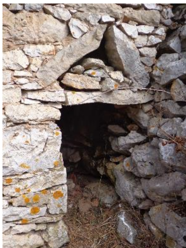
Figura 302 - Fissura em padieira
