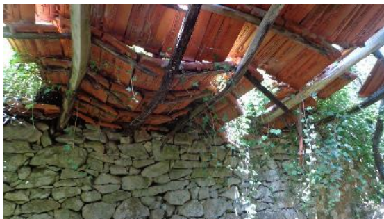
Figura 378 - Lagar: Ação da água na estrutura do telhado (colapso por apodrecimento)
