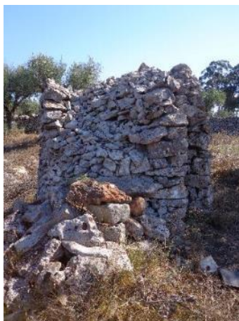
Figura 372 - Abrigo de pastor: Colapso pela ausência de ligação entre paredes e cobertura
