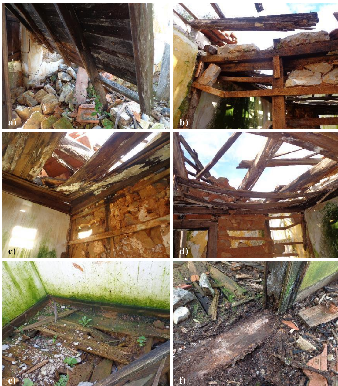
Figura 381 - Ação nefasta da água em estruturas de madeira: a) Colapso do sobrado por apodrecimento dos apoios; b) Colapso da estrutura de enxaimel com dissolução das argamassas; Ação de fungos de podridão no forro; d) Deformação e colapso da estrutura do telhado; e) e f) Apodrecimento do pavimento por contacto com solo húmido e por colapso da cobertura/Colonização biológica por algas e musgos
