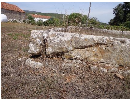
Figura 377 - Fissuras em elementos pétreos/Dissolução de juntas
