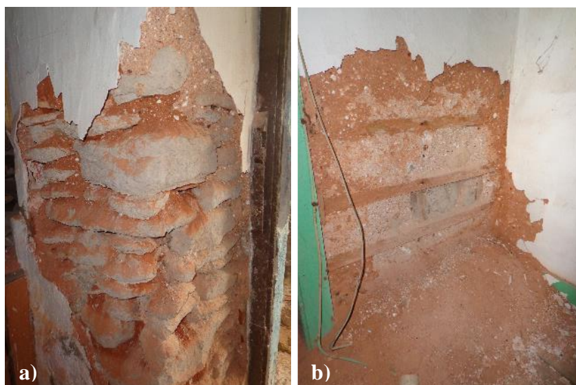
Figura 382 - a) Arenização da pedra por acumulação de sais solúveis induzidos por absorção capilar com dissolução das argamassas; b) Dissolução de argamassas em parede de tabique
