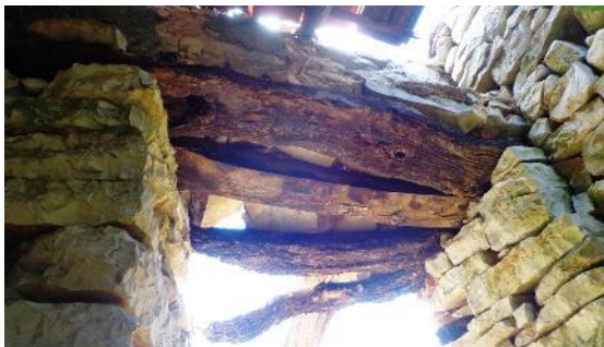
Figura 380 - Destrução das padieiras por fenómenos de podridão e descarga de ações superiores à capacidade resistente
