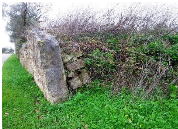
Figura 365 – Provável derrube do muro por rotação entorno da aresta exterior – momento derrubador
