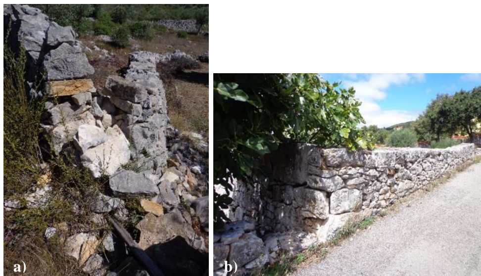
Figura 369 – a) Deficiente travamento na ligação: a) Entre muros; b) Em cunhais
