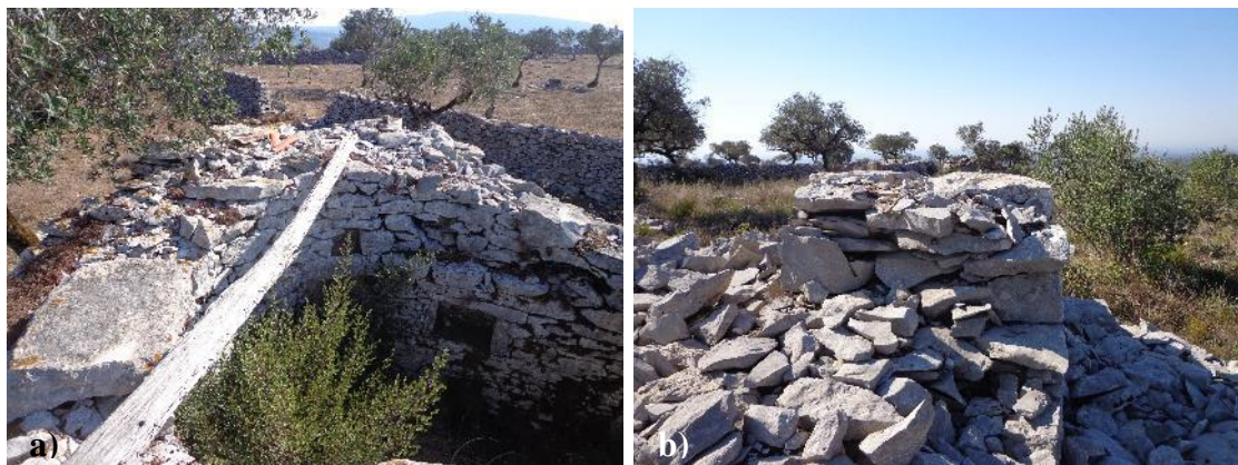
Figura 232 - Moinho: Panos de parede colmatados com escacilhos
