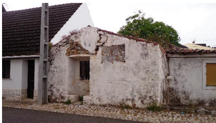
Figura 373 – Cisterna: Fissuras por deficiente consolidação das argamassas e infiltração de águas
