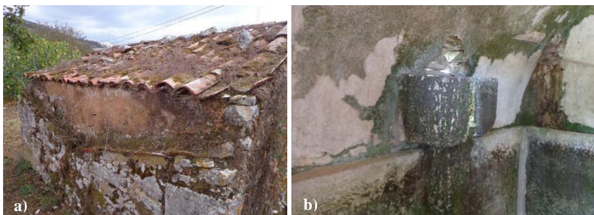
Figura 201 - Cisterna – a) Sistema de recolha de águas pluviais com telhas de canudo; b) Recetáculo das águas pluviais
