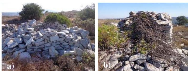
Figura 168 - Abrigo de pastor: a) Colapso total; b) Colapso parcial
