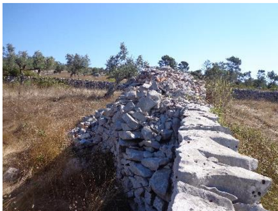
Figura 371 - Abrigo de pastor: Desligamento dos constituintes por deficiência de travamento nas paredes
