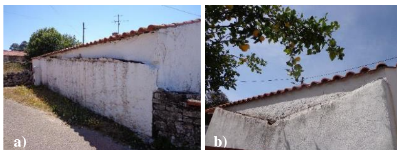
Figura 174 – a) Caleira embutida em parede exterior à edificação; b) Recolha de água em cisterna
