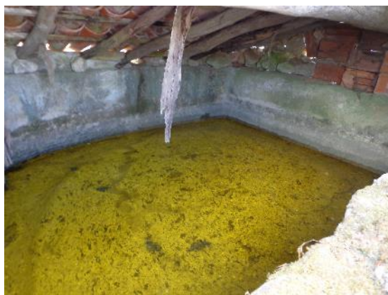
Figura 376 – a) Cisterna: Colonização biológica por algas e florescências
