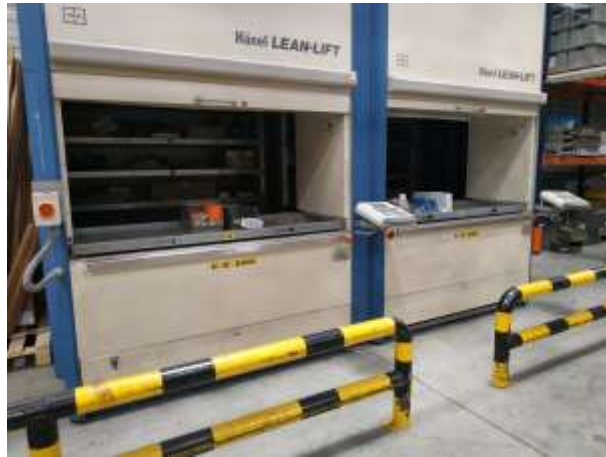
Figura 14 – Zona de Armário (Armário 1 e Armário 2, respetivamente).
