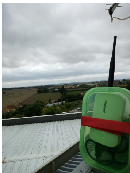
(a) Colocação do Gateway
