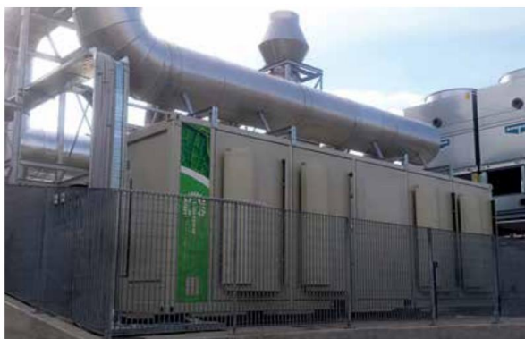
Figura 36 - Exemplo de microturbina instalada [41]
