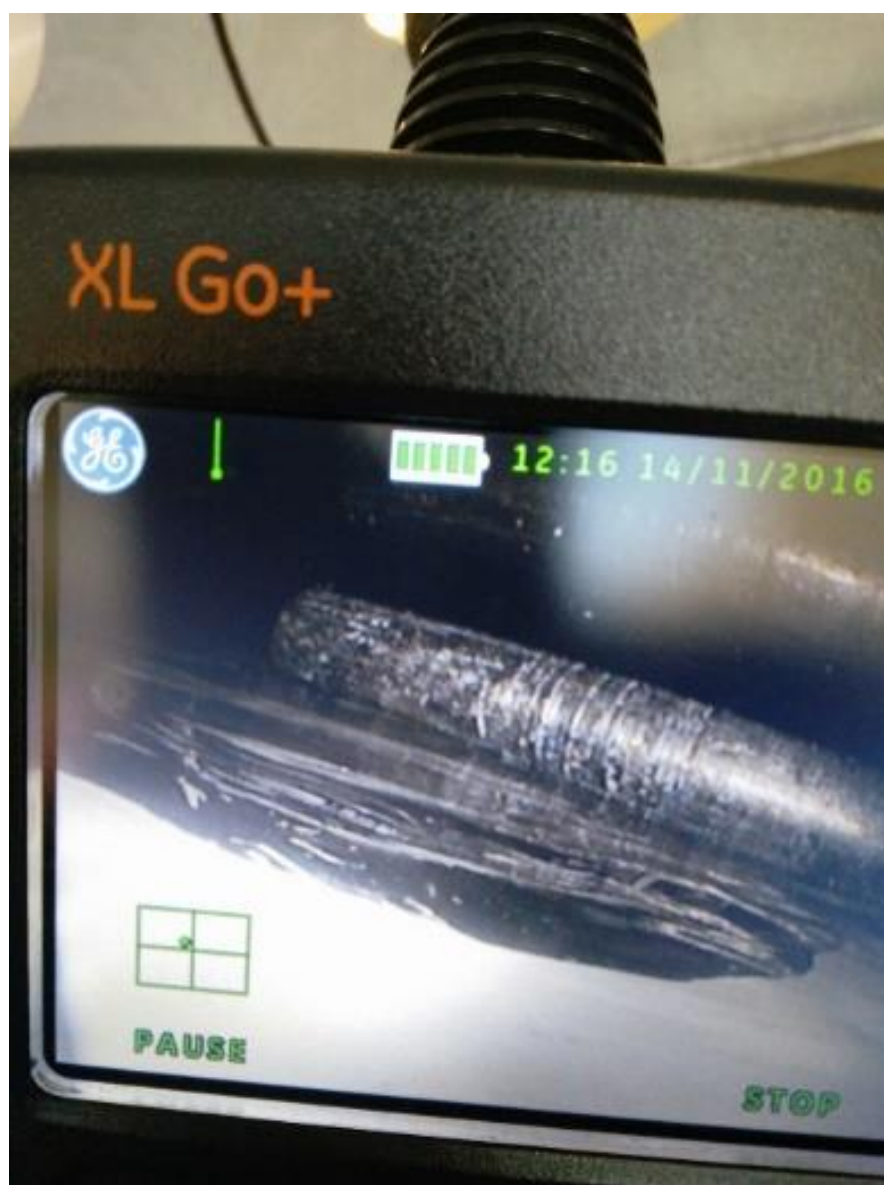
Figura 138 - Broca encontrada no interior do gerador BIWF2 (foto obtida pelo discente)
