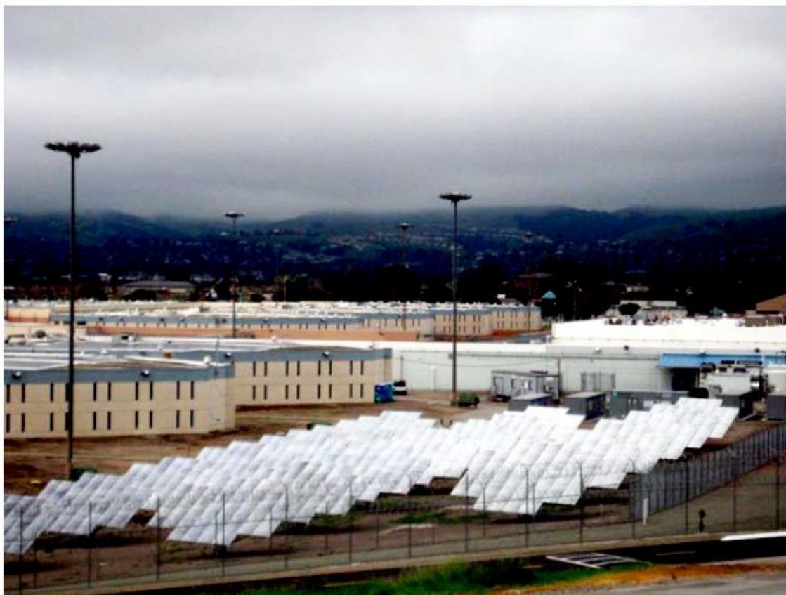
Figura 116 - Vista parcial da prisão de Santa Rita, EUA, com instalação FV [85]
