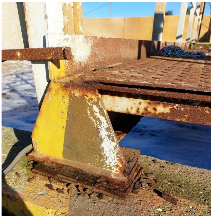
Figura 5.4 – Estado de degradação das bases de apoio do passadiço da vala de oxidação
