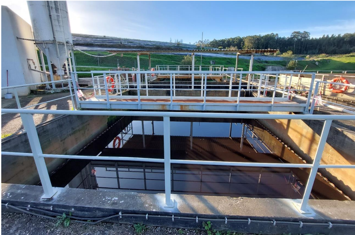
Figura 5.6 – Decantador biológico em primeiro plano, em segundo plano telheiro e decantador físico-químico
