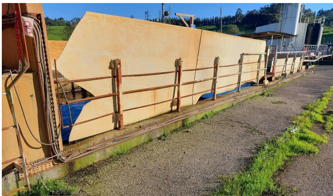
Figura 5.5 – Estado de degradação do gradeamento da vala de oxidação
