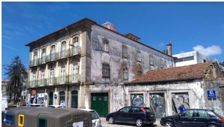
Figura 3: Edifício em elevado estado de degradação.
