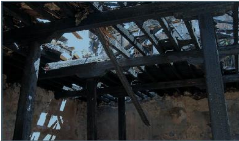
Figura 31: Estrutura de madeira afetada por um incêndio.
