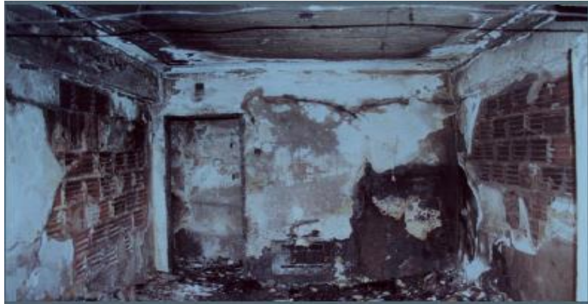
Figura 32: Elementos de alvenaria afetados pelo fogo.
