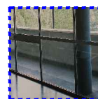
6 - caixilhos em alumínio
