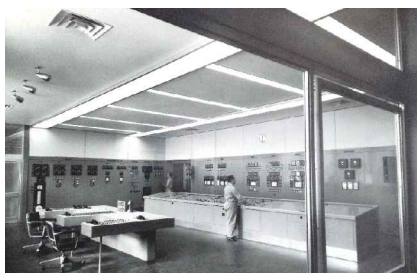
interior sala de comando
