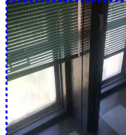
p1 - caixilhos, controle estores
