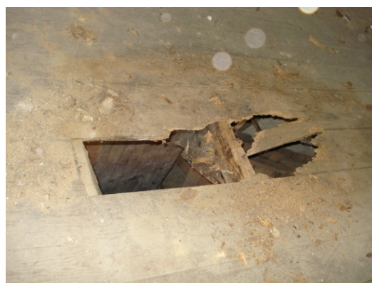
Pavimentos de madeira, em mau estado Fig 129
