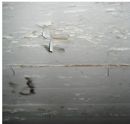
Pintura em destacamento (Tectos) – Fig 127
