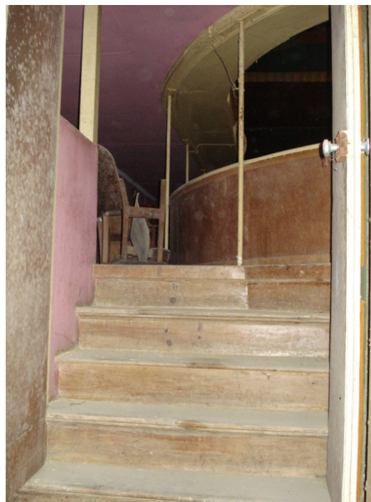
Acesso ao primeiro balcão – Fig 119
