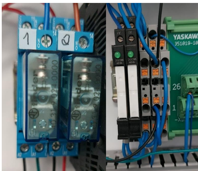
Figura 98 – Relés de proteção Fonte: Própria
