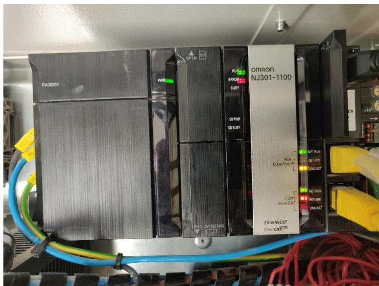
Figura 22 – PLC NJ301 Fonte: Própria
