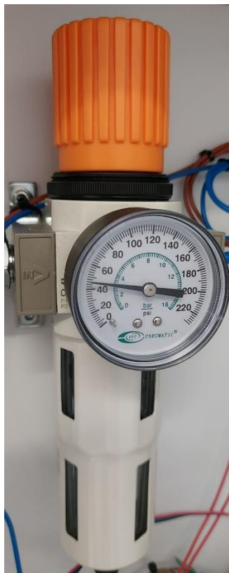
Figura 95 – Regulador de pressão Fonte Própria
