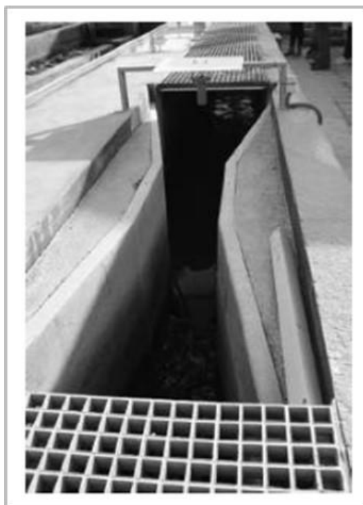
Figura 7- Medidor de caudal Parshall (ESAR, 2016).
