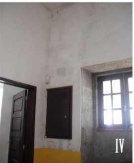
HUMIDADE CAUSADA PELA CONSTRUÇÃO
