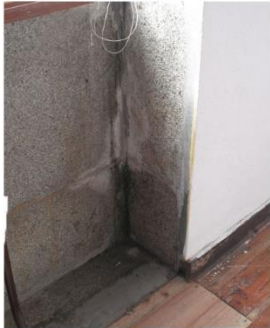
EFLORESCÊNCIAS NA PEDRA
