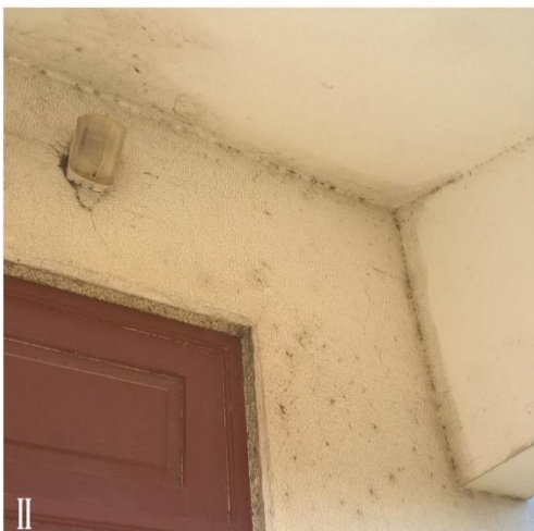
HUMIDADE CAUSADA PELA CONSTRUÇÃO
