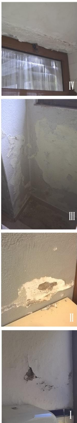
Figura 32. Patologias identificadas na estrutura vertical da escola de D. Adília (fotografias do autor)
