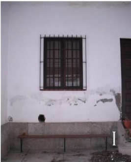
MANCHAS NA ARGAMASSA DE CIMENTO
