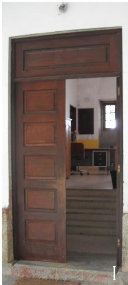
Figura 28. Patologias identificadas na caixilharia, antes das obras de recuperação de 2014. (fotografias de C.M.V.C.)
