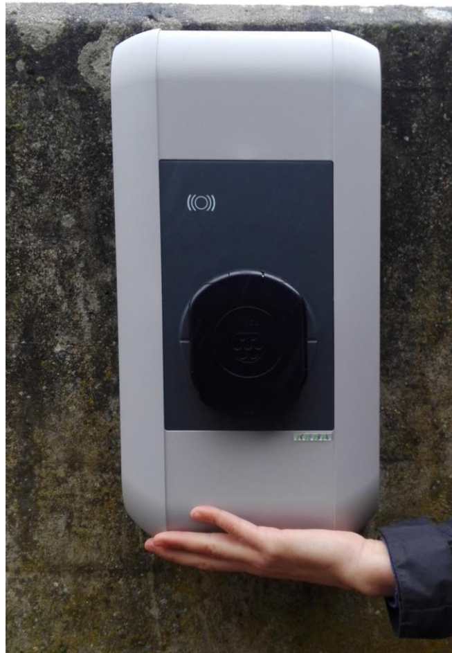
Figura 67-Ensaio da disposição de montagem do carregador na parede da central.
