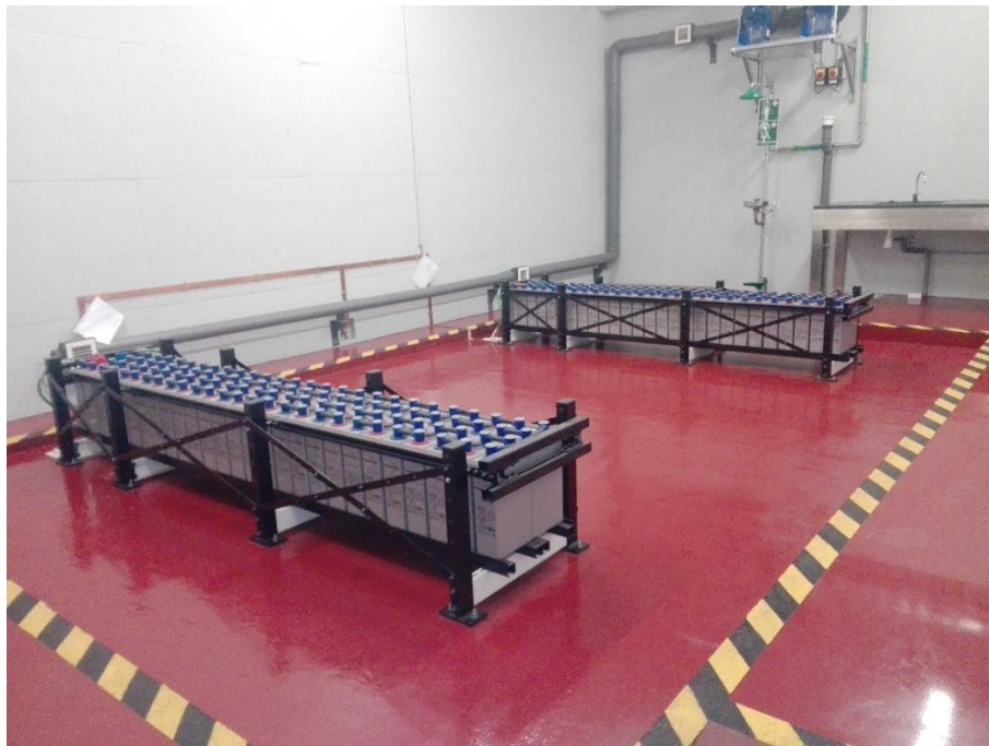
Sala de baterias
