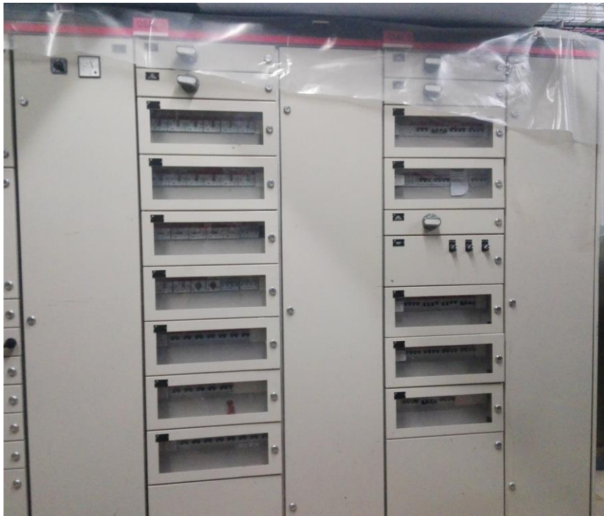
Figura 65-Painel do Quadro de serviços auxiliares externos (QSAE).
