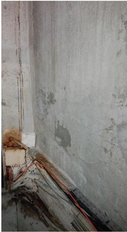
Figura 56-Entrada dos cabos no interior da casa das máquinas.
