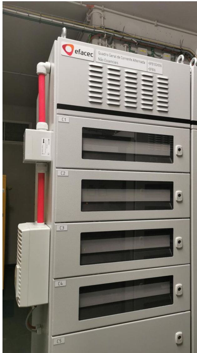
Figura 70-Painel do QGBT dos não essenciais para alimentação dos postos de carregamento.
