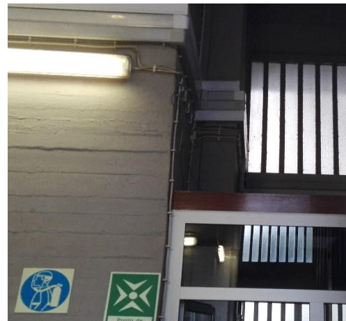
Figura 58-Saída dos cabos para o exterior, por cima do gabinete do vigilante e das calhas existentes.
