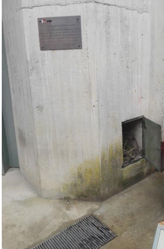
Figura 68-Saída de cabos para o exterior.
