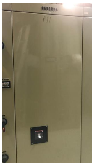
Figura 54-Painel de reserva P11 com o disjuntor respetivo.
