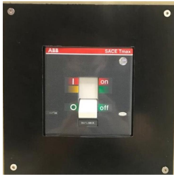
Figura 53-Disjuntor apto ao seccionamento ABB T5N 400 TMA 400-4000 tetrapolar (4p).
