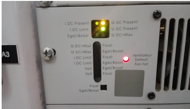
Figura 49-Defeito de ventilação no módulo retificador instalado na rack A3.
