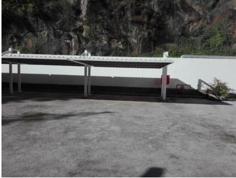
Figura 64-Local de instalação dos carregadores na parede.
