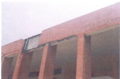
Figura 112 – Desprendimento do tijolo face-à-vista em platibandas [25]
