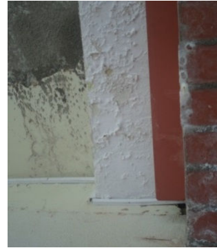
Figura 133 – Empolamento na viga do edifício B
