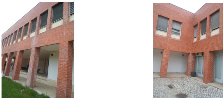
Figura 108 – Eflorescências visíveis nas fachadas dos edifícios
