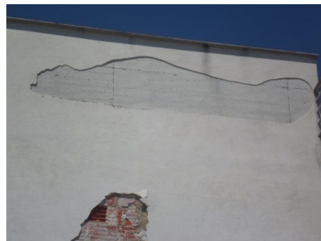
Figura 128 – Destacamento do reboco na zona de platibanda
