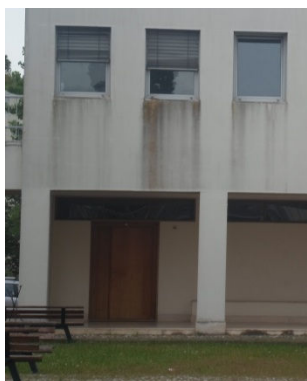
Figura 180 – Líquenes presentes no revestimento de isolamento térmico pelo exterior
