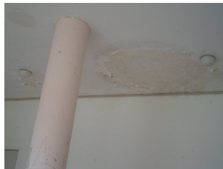
Figura 166 – Manchas de humidade junto a um ponto de iluminação
