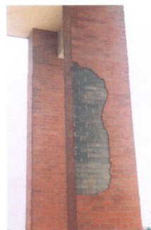
Figura 113 – Desprendimento do tijolo face-à-vista em pilares [25]
