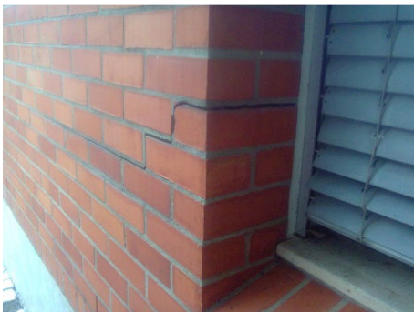
Figura 144 – Fendilhação em tijolo face-à-vista
