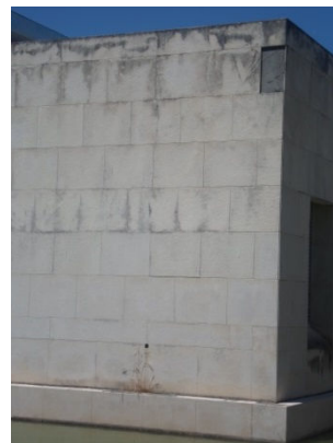
Figura 174 – Destacamento em placas de pedra
