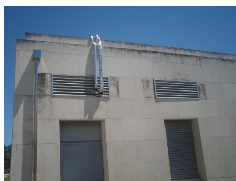
Figura 139 – Crostas negras junto a tubagem
