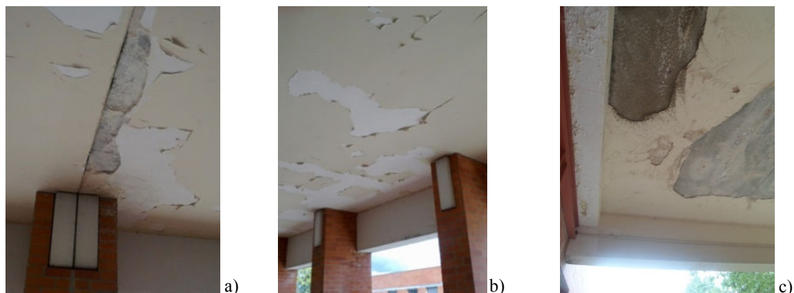
Figura 129 – Destacamento do revestimento em tetos dos edifícios A, B e O
