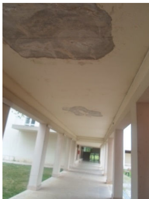
Figura 173 – Destacamento em reboco
