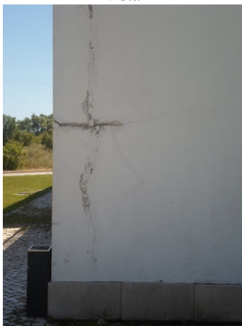
Figura 146 – Fendilhação em isolamento térmico pelo exterior
