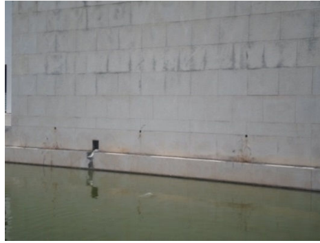
Figura 140 – Colonização biológica no revestimento
