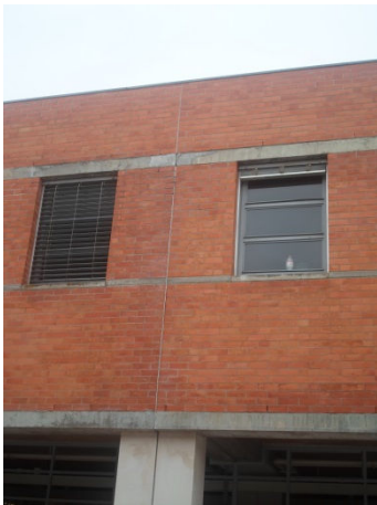
Figura 159 – Manchas de humidade no tijolo face-à-vista
