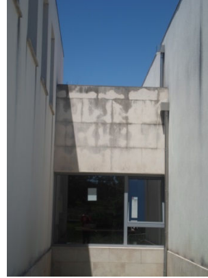
Figura 183 – Crostas negras em revestimento de placas de pedra
