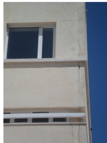
Figura 147 – Fendilhação em reboco
