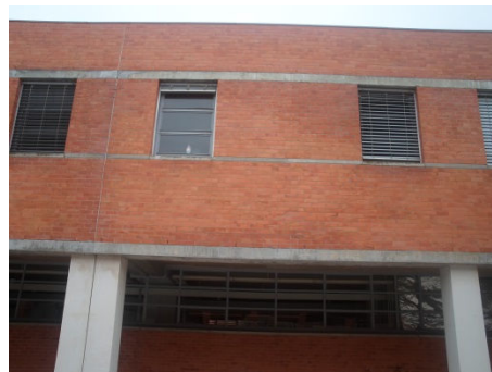
Figura 167 – Manchas de humidade no revestimento em tijolo face-à-vista
