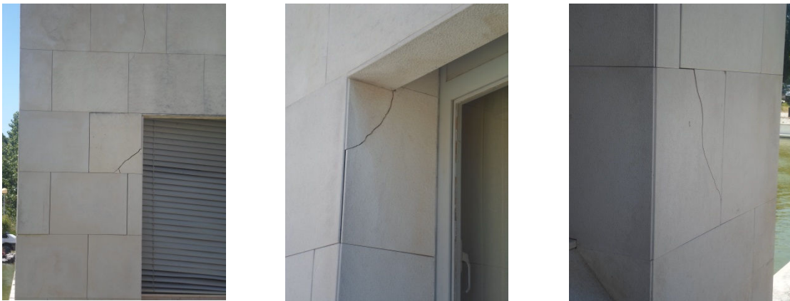
Figura 141 – Vários exemplos de fissuração
