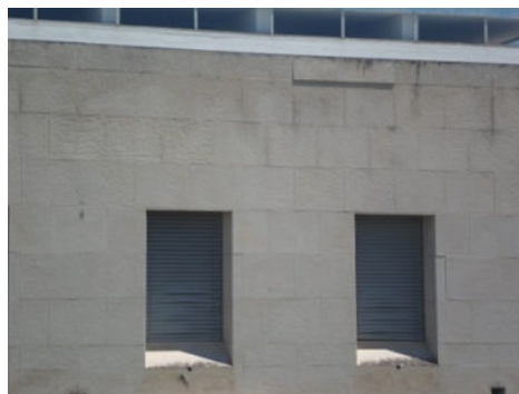
Figura 143 – Desprendimento parcial do revestimento
