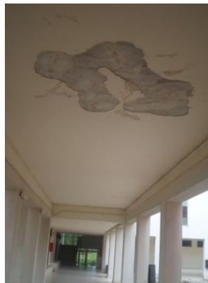
Figura 177 – Destacamento parcial do reboco
