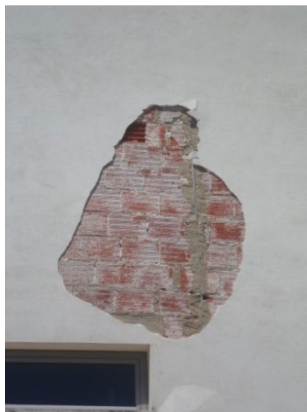
Figura 127 – Destacamento do reboco em zona corrente da alvenaria
