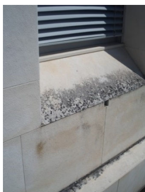
Figura 136 – Crostas negras no peitoril da janela
