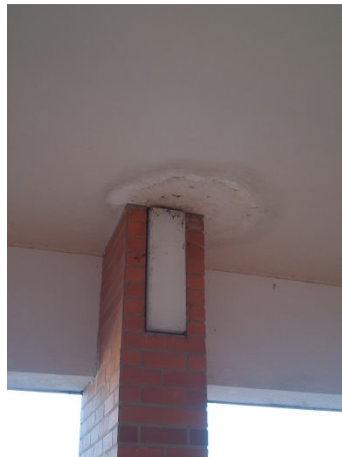
Figura 160 – Manchas de humidade no reboco
