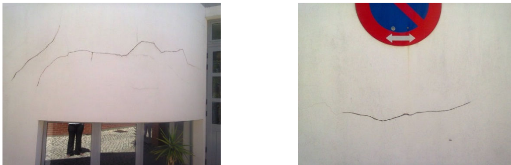
Figura 155 – Fissuras nas alvenarias
