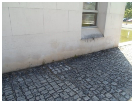
Figura 135 – Manchas de humidade junto ao solo
