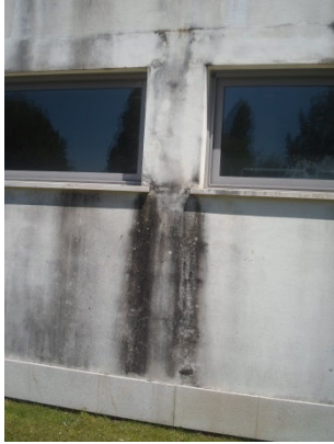
Figura 182 – Crostas negras em revestimento de isolamento térmico pelo exterior
