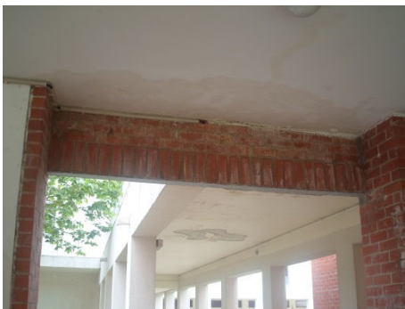
Figura 165 – Manchas de humidade junto a uma viga
