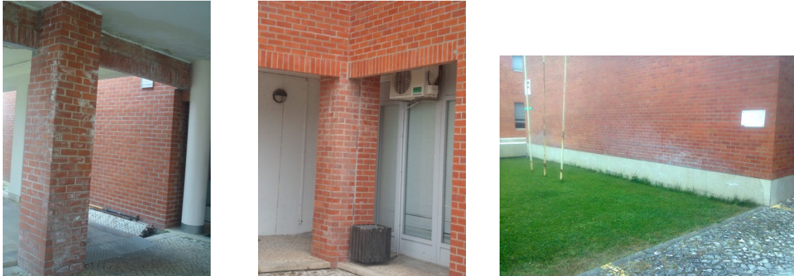
Figura 179 – Eflorescências em tijolo face-à-vista
