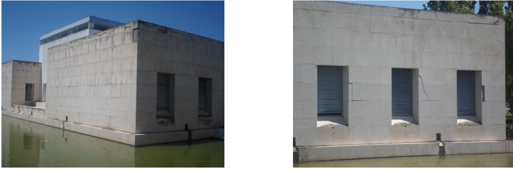
Figura 175 – Destacamento das placas de pedra
