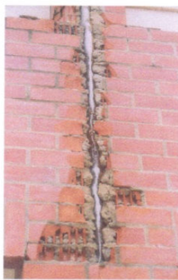
Figura 110 – Fendilhação vertical junto a tubos de queda [25]
