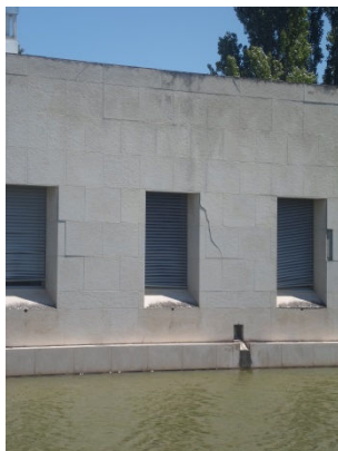
Figura 168 – Manchas de humidade no revestimento em pedra
