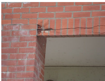
Figura 178 – Rotura em revestimento cerâmico situada na fachada oeste do edifício B
