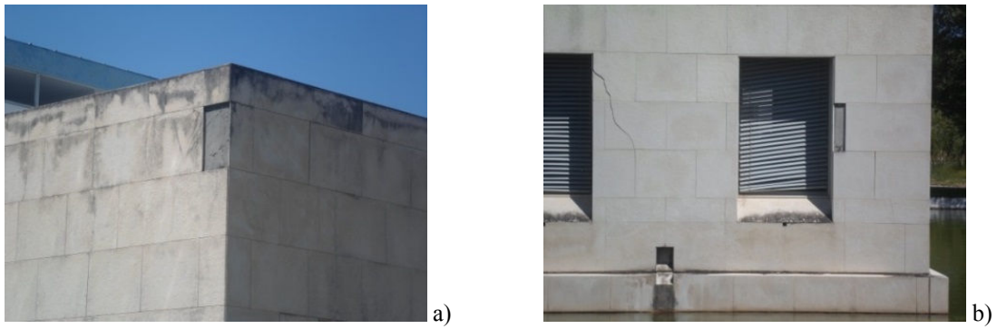
Figura 142 – Exemplos de destacamento do revestimento
