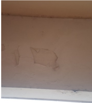
Figura 132 – Empolamento na viga do edifício A
