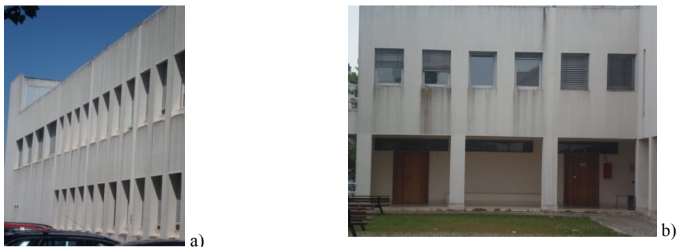
Figura 124 – Manchas negras no edifício O
