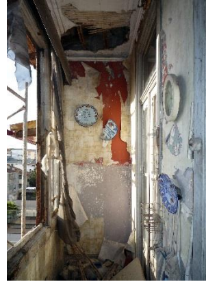
Fig.96- Degradação das traseiras
