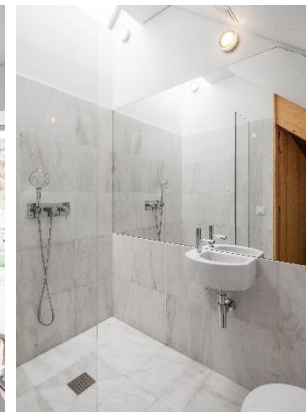
Fig.90- Instalação sanitária (piso 2)
