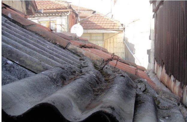
Fig.124- Descaracterização da cobertura
