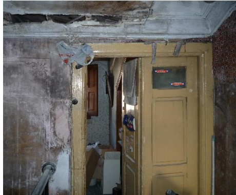
Fig.97- Degradação da cobertura e rebocos
