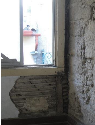
Fig.123- Degradação do interior da fachada
