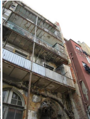
Fig.171- Varanda tardoz em risco de colapso
