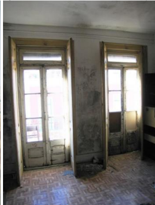
Fig.174- Manchas no interior da fachada
