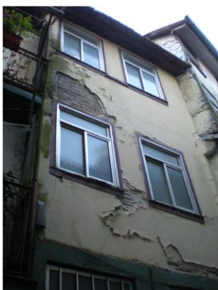
Fig. 121- Degradação das paredes de frontal
