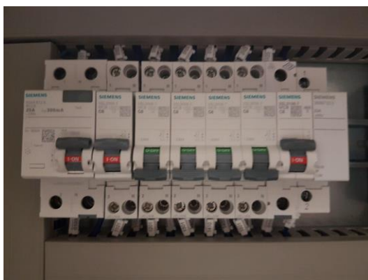
Figura 31 - Disjuntores e diferencial do quadro elétrico dos caudalímetros
