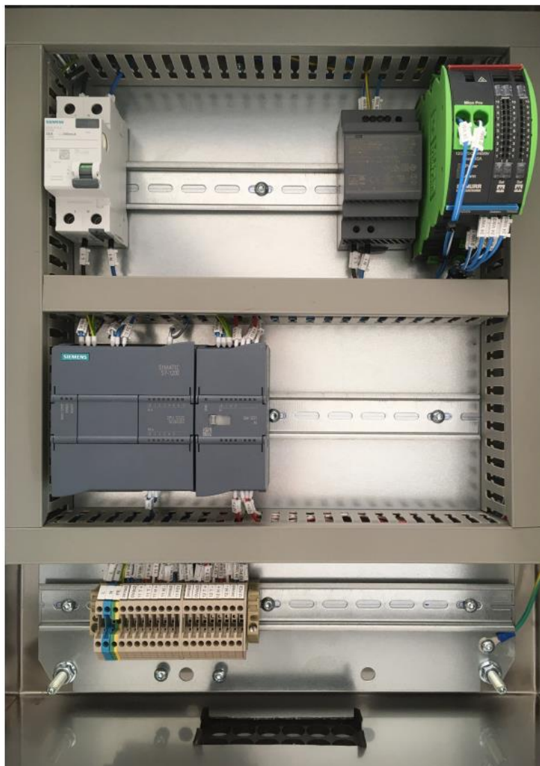
Figura 64 – Visão geral do quadro elétrico do projeto das câmaras de refrigeração
