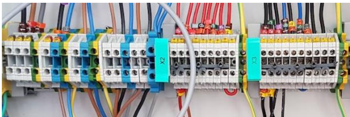
Figura 56 – Bornes usados no quadro elétrico de doseamento automático do cloro
