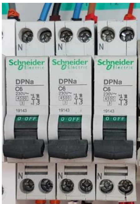
Figura 54 – Disjuntores usados no quadro elétrico de doseamento automático de cloro
