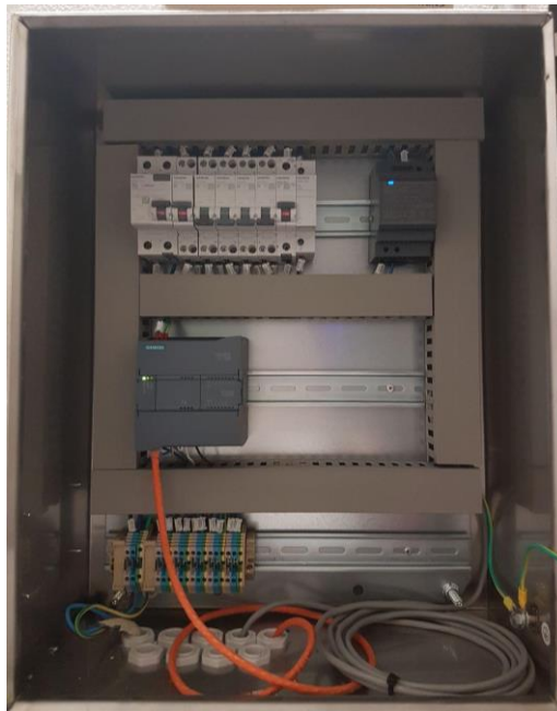
Figura 29 – Vista geral do quadro elétrico dos caudalímetros
