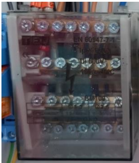
Figura 55 – Barramento tetrapolar de 500V
