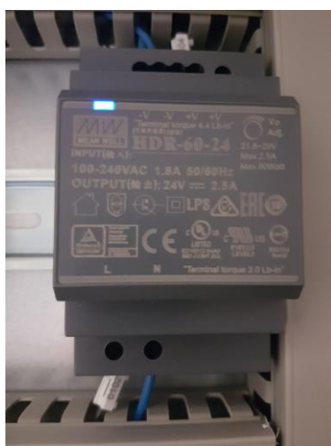
Figura 30 - Fonte de alimentação do quadro elétrico dos caudalímetros
