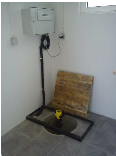
Figura 4- Logger e Radar interior Abrigo
