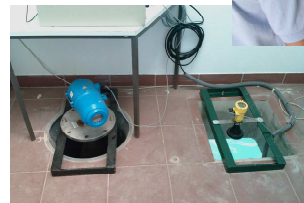
Marégrafos de sensor de radar
