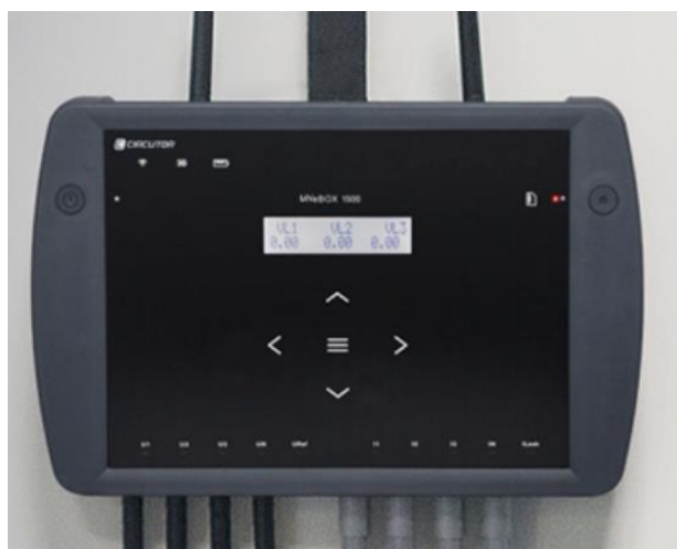
Figura 25 - Analisador de energia
