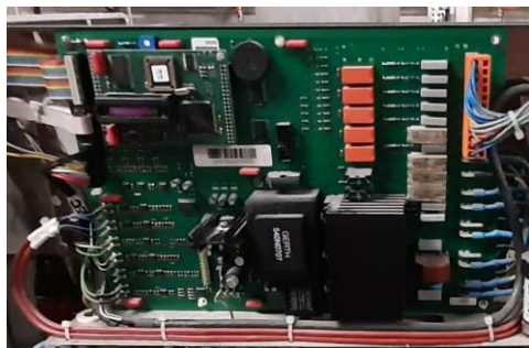
Figura 33. Placa de controlo da esterilização.
