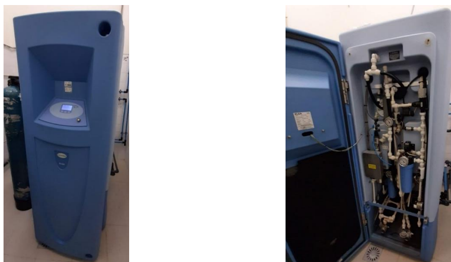
a) b) Figura 40. Purificador de água. a) Visão externa. b) Composição interna de filtros e tubagens.
