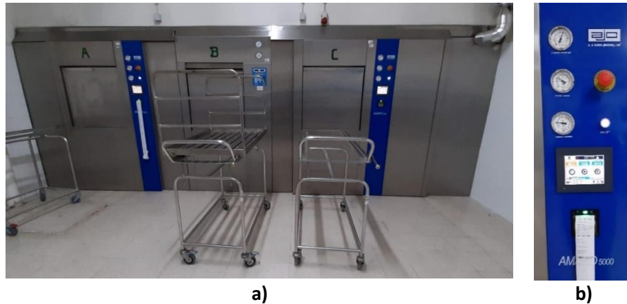
Figura 30. Autoclaves intervencionados. a) Conjunto de autoclaves intervencionados. b) Painel de comando.
