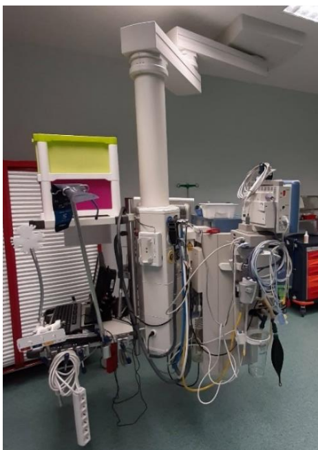
Figura 58. Pendente hidráulico de um bloco operatório.
