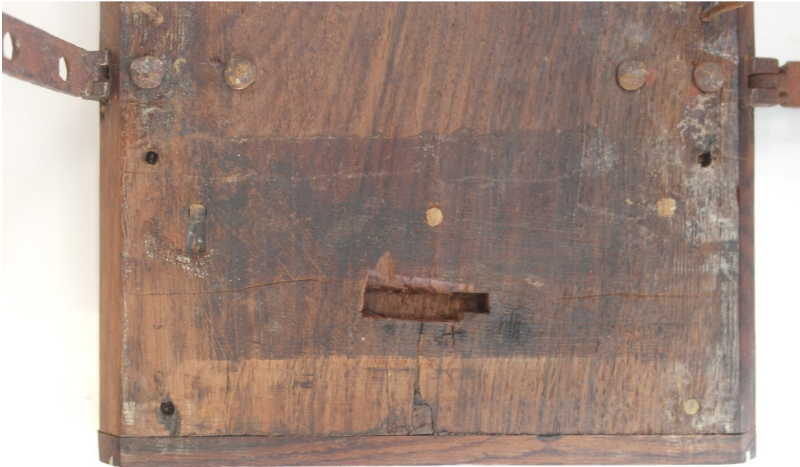
Figura 79- Sulco para encaixe da lingueta da fechadura das gavetas, aparentemente alterada.
