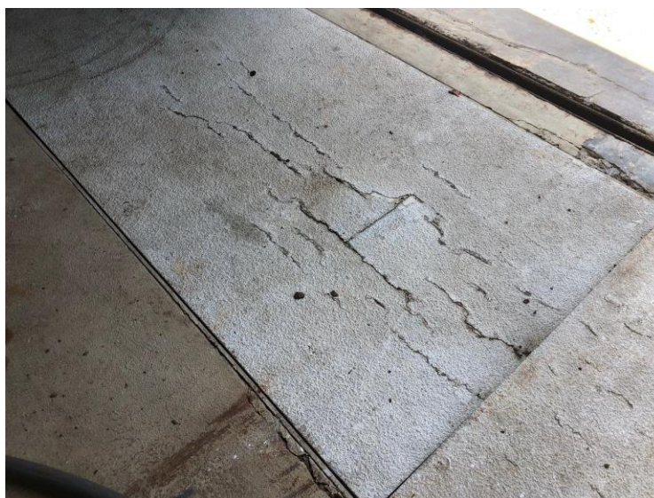
Fig. 130 – Fissuras tampa ETAR Barreiro (Autor, 2021).
