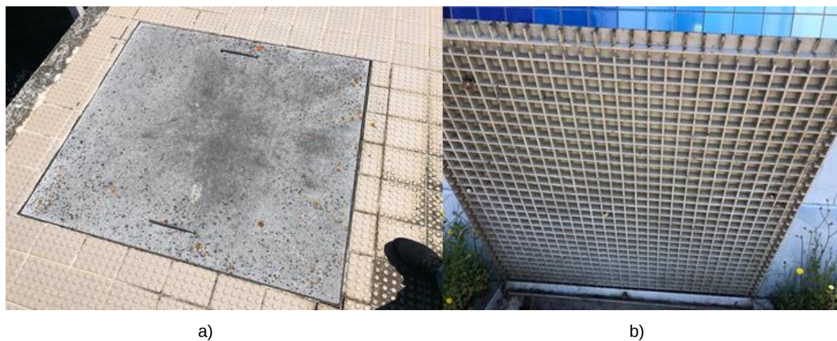
Fig. 125 – a) Tampa e b) grelha em GFRP, ETA Asseiceira (Autor, 2021).
