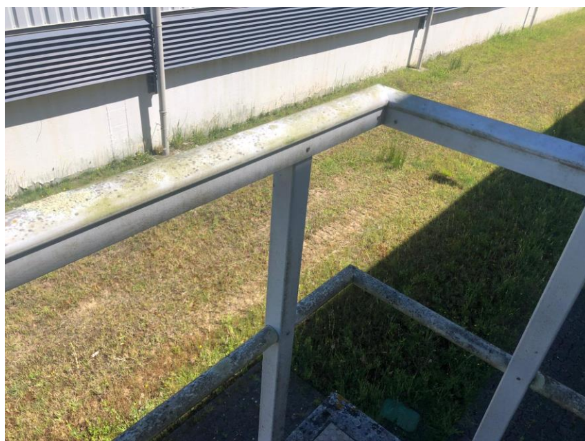
Fig. 128 – Degradação da pintura ETA Asseiceira (Autor, 2021).
