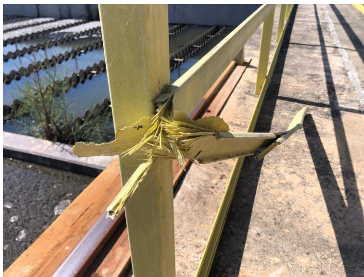
Fig. 129 – Degradação guarda ETAR Barreiro (Autor, 2021).
