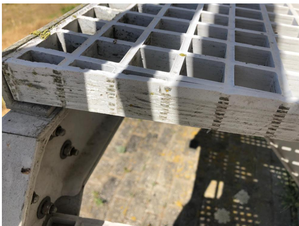
Fig. 126 – Fibras expostas ETA Asseiceira (Autor, 2021).
