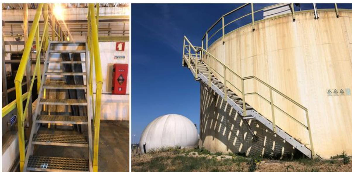
Fig. 123 – Escada em perfis GFRP ETAR Barreiro (Autor, 2021).
