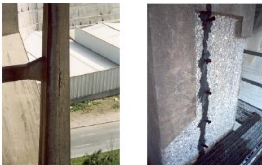
Fig. 100 – Fendilhação em betão e trabalho de injeção (Costa et al. , 2004).
