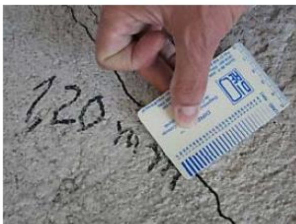
Fig. 105 – Fenda transversal com 1,20 mm na laje inferior (Branco, 2014).
