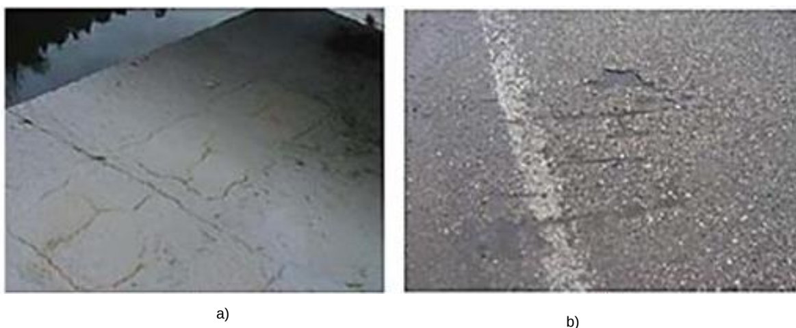
Fig. 104 – Deterioração dos materiais: a) Zona de esmagamento dos pilares; b) Desgaste do pavimento (Branco, 2014).
