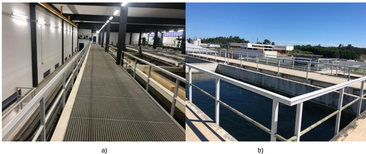
Fig. 124 – Estrutura em perfis GFRP, a) passadiço, b) guardas, ETA Asseiceira (Autor, 2021).
