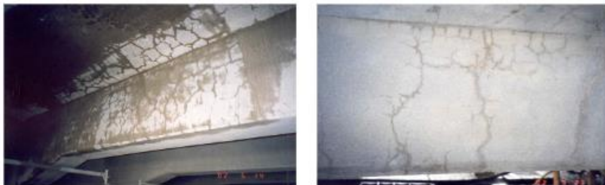
Fig. 99 – Fendilhação típica das reacções alcalo-sílica no betão nas vigas do tabuleiro (Costa et al. , 2004).
