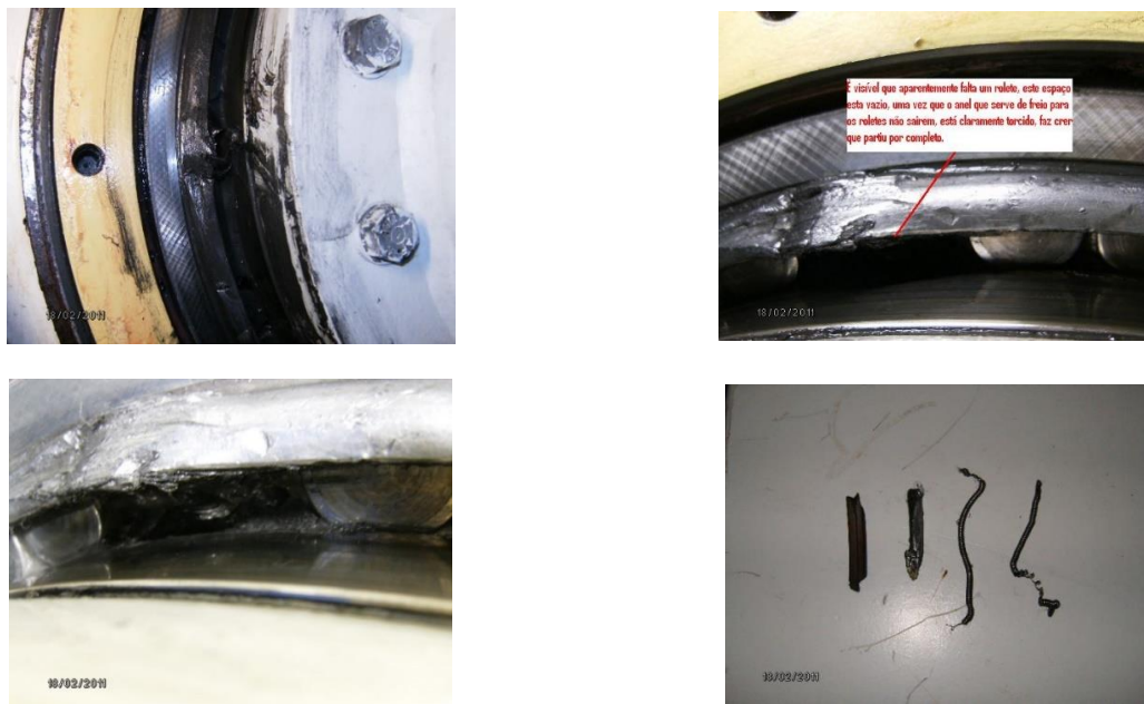
Figura 4.26: Rolamento frontal danificado aerogerador Enercon do modelo E66.
