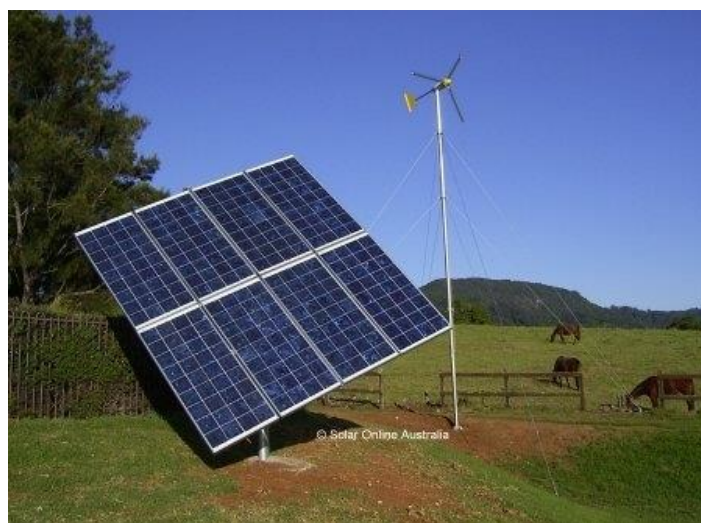
Figura 3.16: Turbina eólica de pequena dimensão associada a painéis fotovoltaicos [27].
