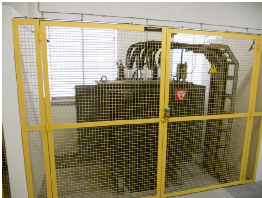
Figura 7 – Posto de Transformação, Instalações Especiais – Elétricas
