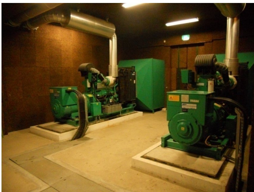
Figura 6 – Sala dos Grupos Geradores, Instalações Especiais – Eléctricas
