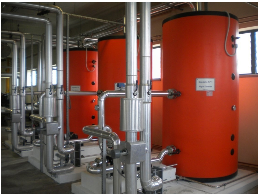
Figura 11 – Depósitos de Águas Quentes Sanitárias
