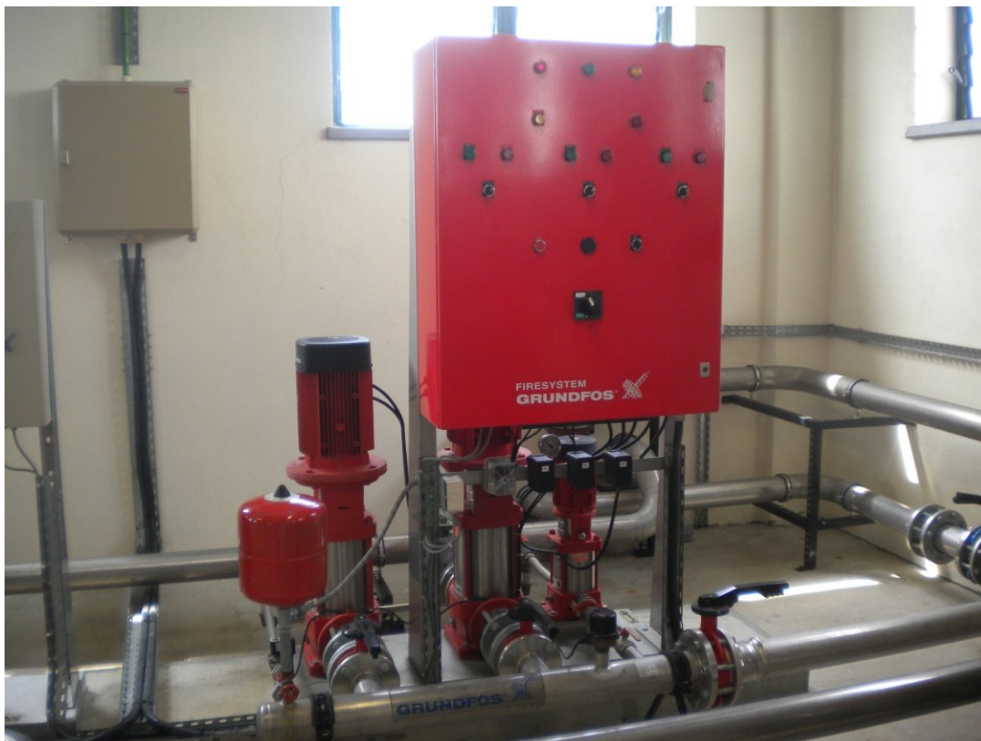
Figura 10 – Grupo Hidropressor de Incêndios
