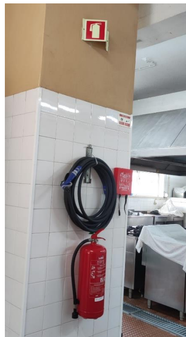
Figura 31 Extintor e Manta Ignífuga da cozinha da escola básica 2,3 de Pataias
