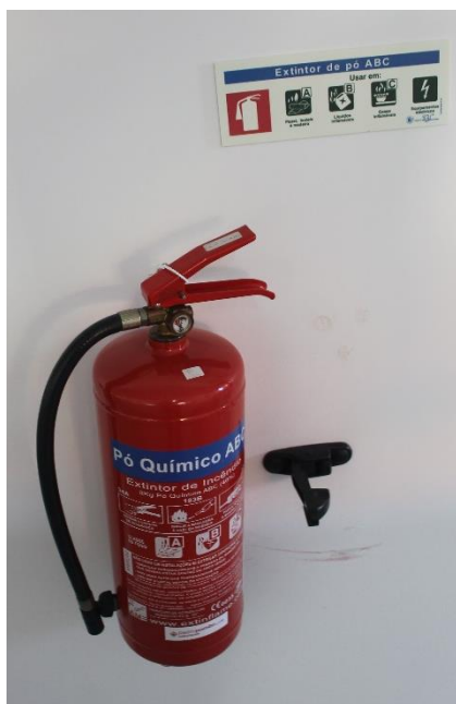
Figura 19 Extintor de Pó Químico do CAPP
