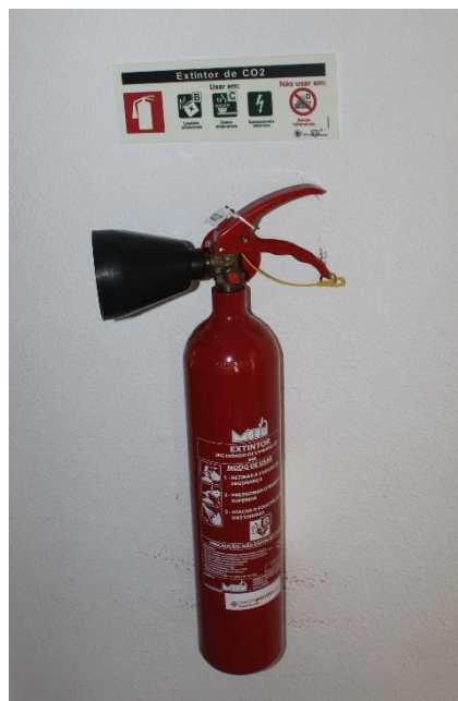
Figura 20 Extintor de CO 2 do CAPP
