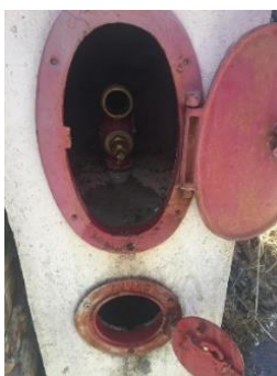
Figura 12 Boca de Incêndio
