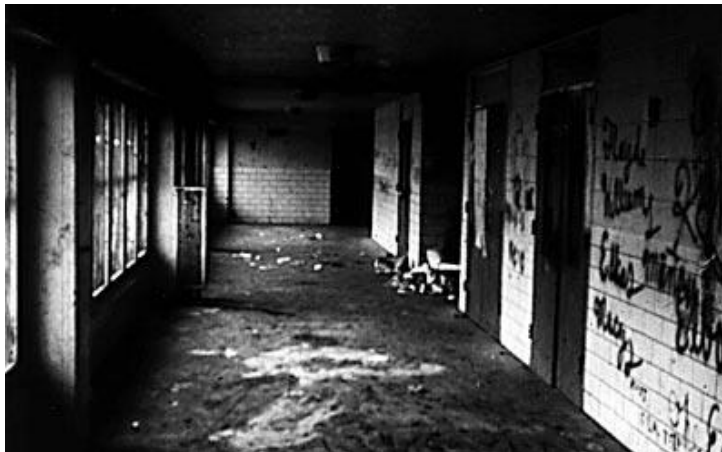
Imagem 2 Corredor comum do 3º andar vandalizado passados 10 anos
