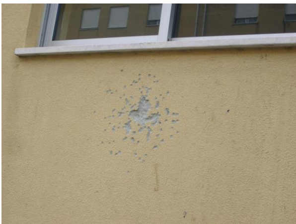
Imagem 34: Marcas de projectéis nas paredes da 2ªEsquadra
