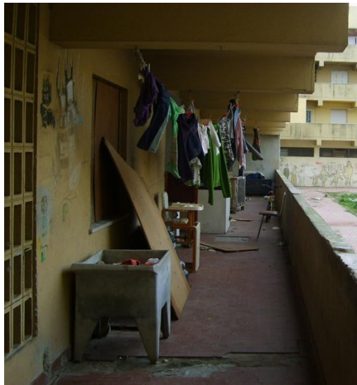
Imagem 39: Aspecto degradado dos corredores e do edifício
