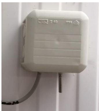
Figura 28 - Exemplo da sonda existente nos secadores
