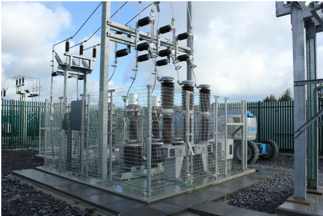
Figura 34 - Estruturas elétricas de uma subestação, (HVM Engineering, 2020)
