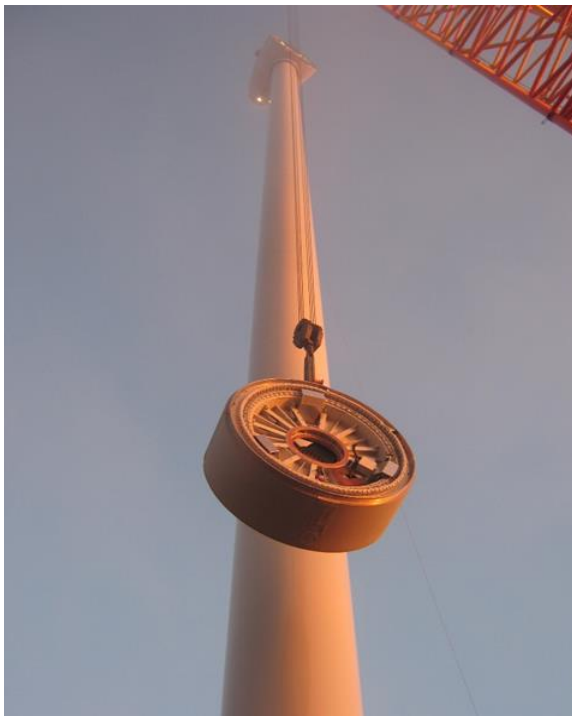
Figura 44- Subida do gerador
