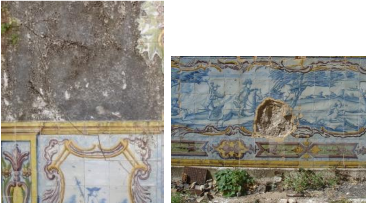
Figura 201 - Fratura estrutural que vem da cantaria da janela e atravessa de forma vertical o azulejo.
