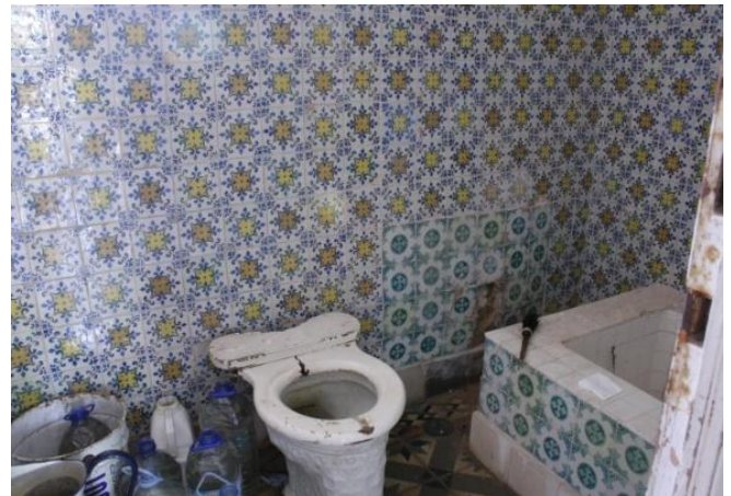
Figura 145 - Mistura de padrões. Zona ao lado da banheira com grande barriga.
