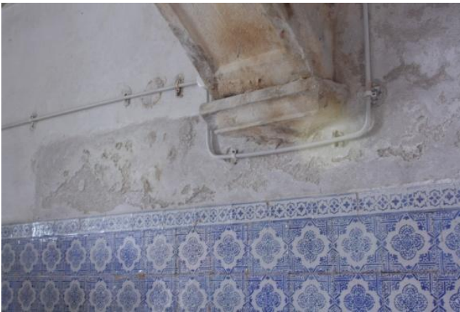
Figura 142 - Manchas de humidade que percorre a sala.
