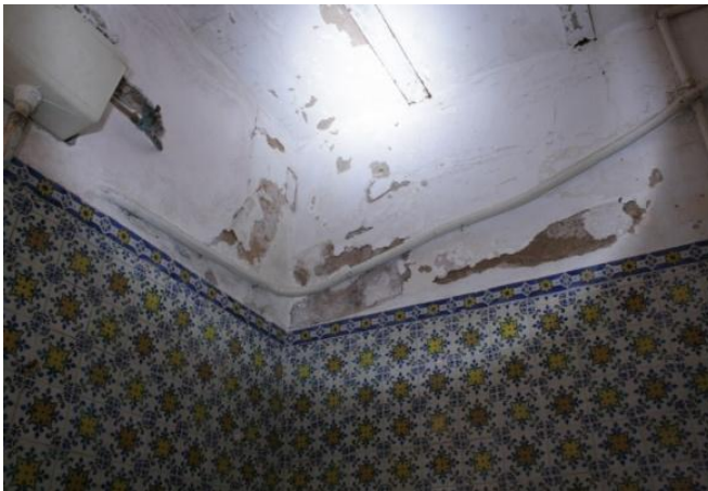
Figura 144 - Percebe-se que existem infiltrações no local.
