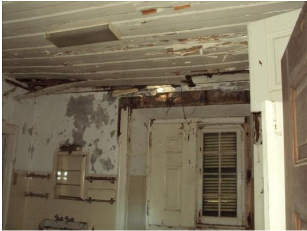
Figura 175 - Zona de perigo eminente, estando o telhado a ruir.
