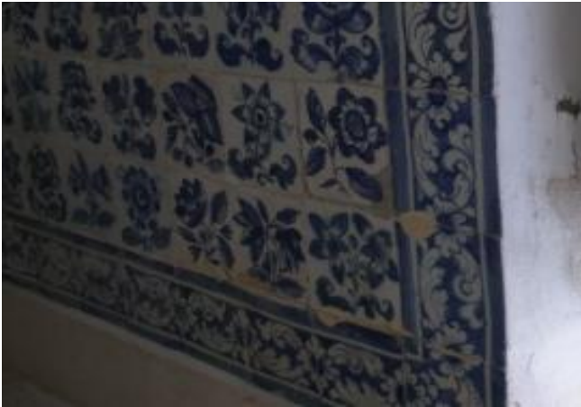
Figura 148 - Fraturas e fissuras com destacamento de vidrado.
