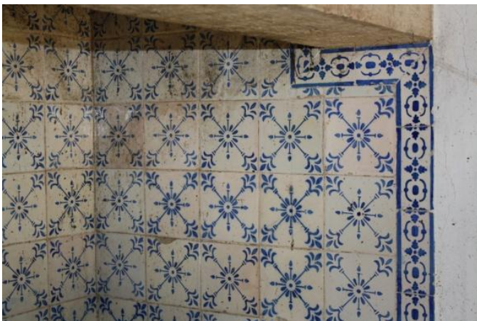
Figura 127 - Os azulejos encontram-se com bastante sujidade e gorduras.
