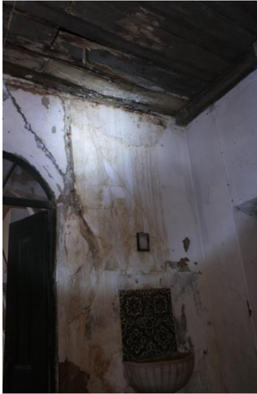
Figura 151 - Local de grandes infiltrações com a cedência do tecto. Perigo de ruir.
