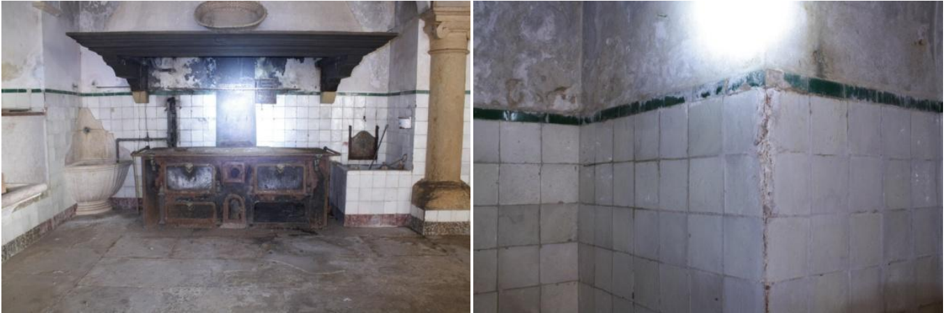
Figura 159 - No lado oeste, onde se encontra o fogão e o forno a lenha, é onde os azulejos se encontram em pior estado de conservação.
