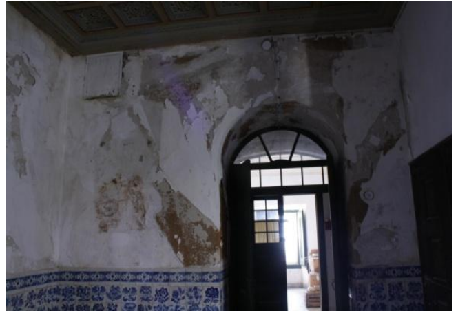
Figura 149 - Zona de infiltrações que afetam o reboco e por sua vez o azulejo, levando a que as argamassas percam a coesão.
