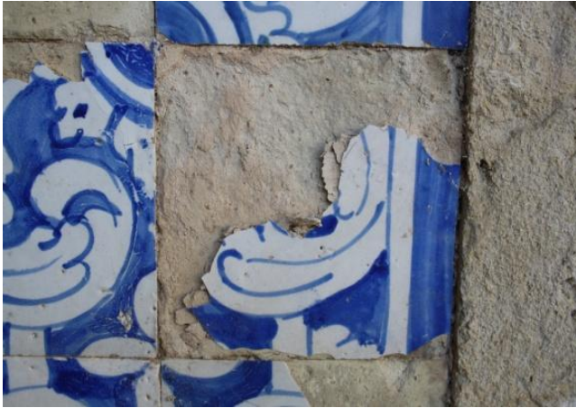
Figura 193 - Em algumas zonas existe desagregação da chacota.
