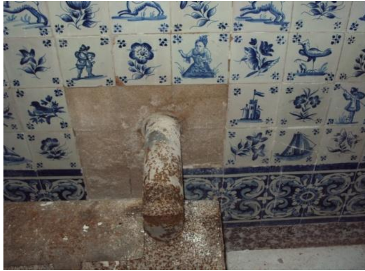
Figura 182 - Há a perda de 8 azulejos junto a tubagens da caldeira.
