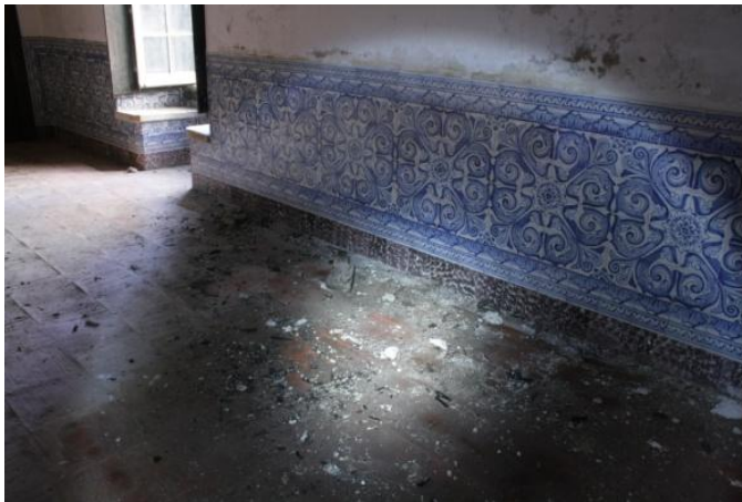
Figura 153 - Este local encontra-se em perigo do tecto ruir.
