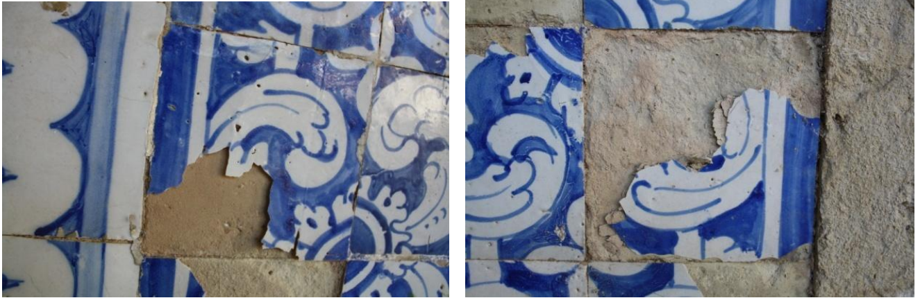
Figura 233 – Exemplo do destacamento de vidrado em que está parcialmente separado da chacota. Neste caso no pátio grande (Maio 2015).
