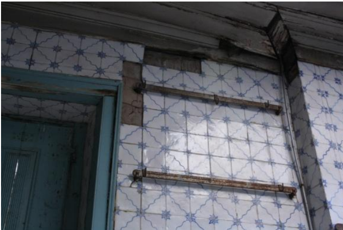
Figura 164 - Falta de alguns azulejos.
