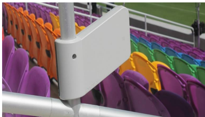
Fig.50: Ponto WIFI do Orlando City Stadium Fonte: Orlando City SC
