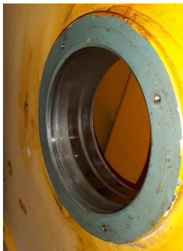
Figura 59 - Caixa dos rolamentos com desgaste.
