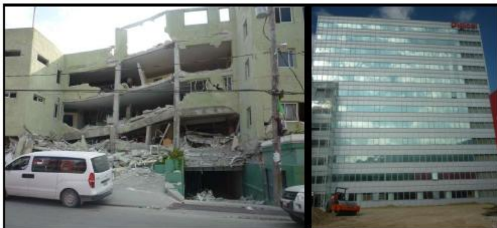
Figura 1.3 – Danos em construções localizadas na mesma rua, frente a frente(6)
