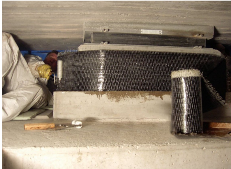
Figura 16- Exemplo de manta em plinto de aparelho de apoio de obra de arte (Ficha Técnica/catálogo S&P – C-Sheet 240)
